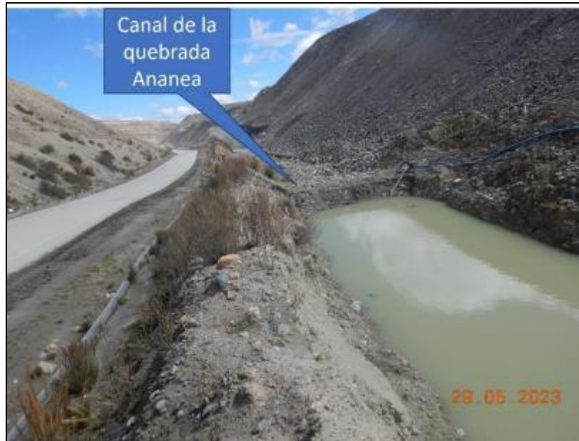
Figura 4. Se aprecia el canal principal de la quebrada Sillacunca obstruida y con material de relaves.
