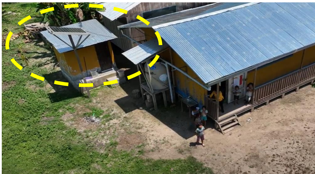
Imagen N° 5: Servicio de Energía eléctrica
