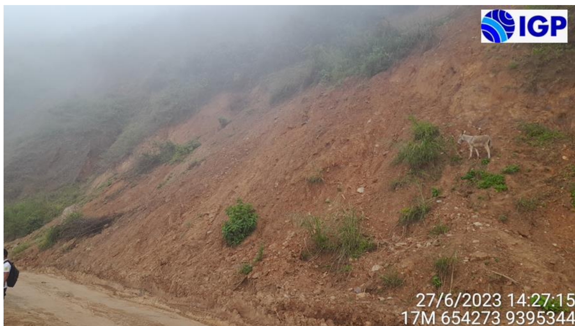
Figura 19.- Deslizamiento localizado a 560 m al oeste del poblado Chamelico que afecta vía de acceso principal
