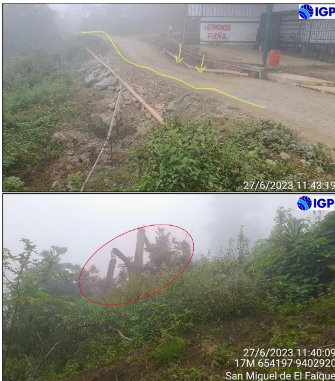
Figura 14.- Evidencias del deslizamiento ocurrido en la parte baja del grifo, la imagen superior muestra el asentamiento de la vía de acceso con dimensiones máximas de 1 m, en la imagen inferior se aprecia una vivienda asentada sobre la ladera que colapsó durante los años 2017 y 2019
