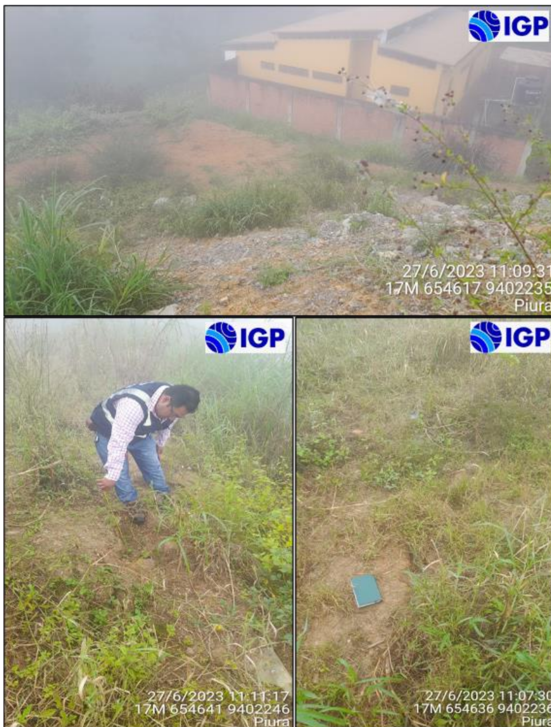
Figura 15.- Depósito de materiales excedente (DME) ubicado en sector Villa Flor, la imagen superior muestra que, contiguo a esta estructura se sitúa camal municipal y la imagen inferior corresponde a grietas en la parte superior del DME cubiertas por vegetación, que presentan longitud de 3 a 4 m y espesores variables de 0.10 a 0.20 m
