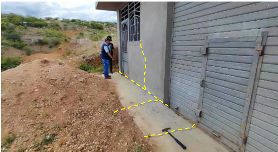
Figura 13. Agrietamientos en una vivienda ubicada detrás de la corona del deslizamiento Los Libertadores. Coordenadas, E: 782911; N: 9361983.
