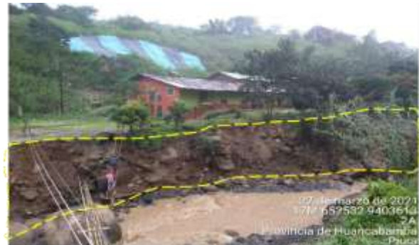
Erosión en el talud de ambas márgenes de la quebrada Pusmalca. Las viviendas asentadas en la margen derecha de la quebrada se encuentran en riesgo
