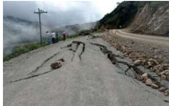
Grietas de 0.20 m de ancho y profundidades de 1.20 m, así como asentamientos diferenciales en la vía Canchaque – Huancabamba
