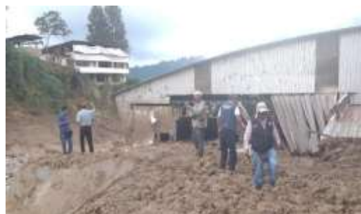
Foto N.º 02. Coliseo deportivo Canchaque ubicado en el margen derecho de la quebrada Limón, que ha sido afectado
