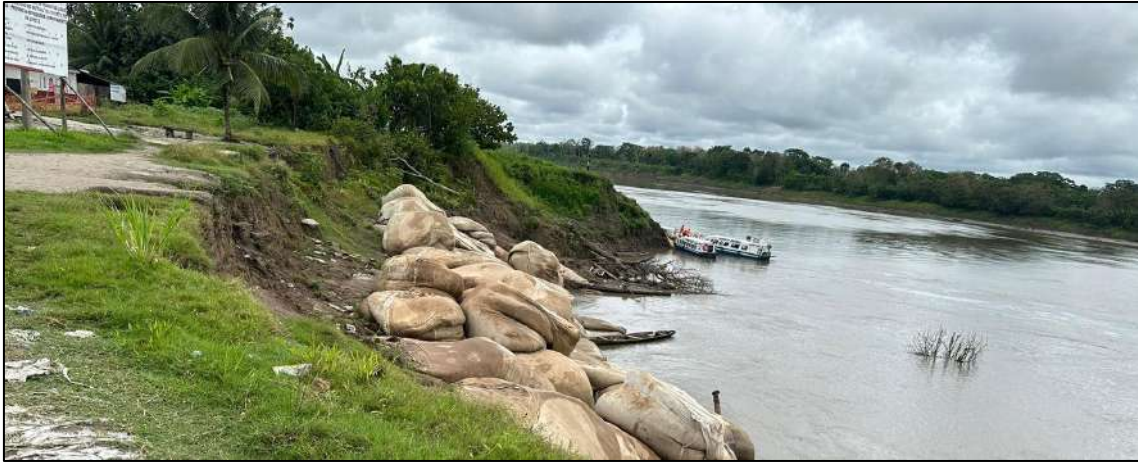
Foto 5. Sector Muelle Bajo Bretaña erosionado, con bolsas de arena.
