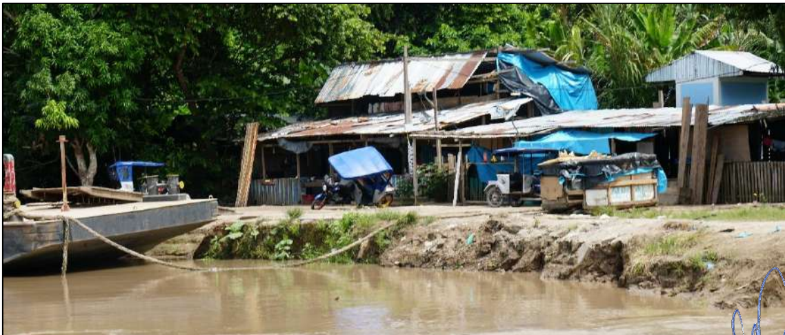
Foto 7. Sector Muelle Alto Bretaña erosionado, cerca de viviendas
