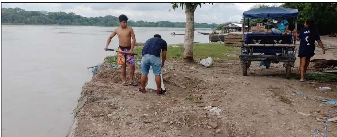
Foto 4. Pobladores llenando bolsas de tierra, para protección ante la erosión
