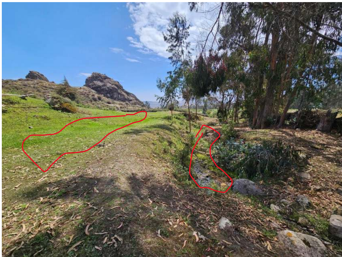
Figura N° 15: Filtraciones (Oconal) del paramento lateral aguas abajo de la presa Ullancay.
