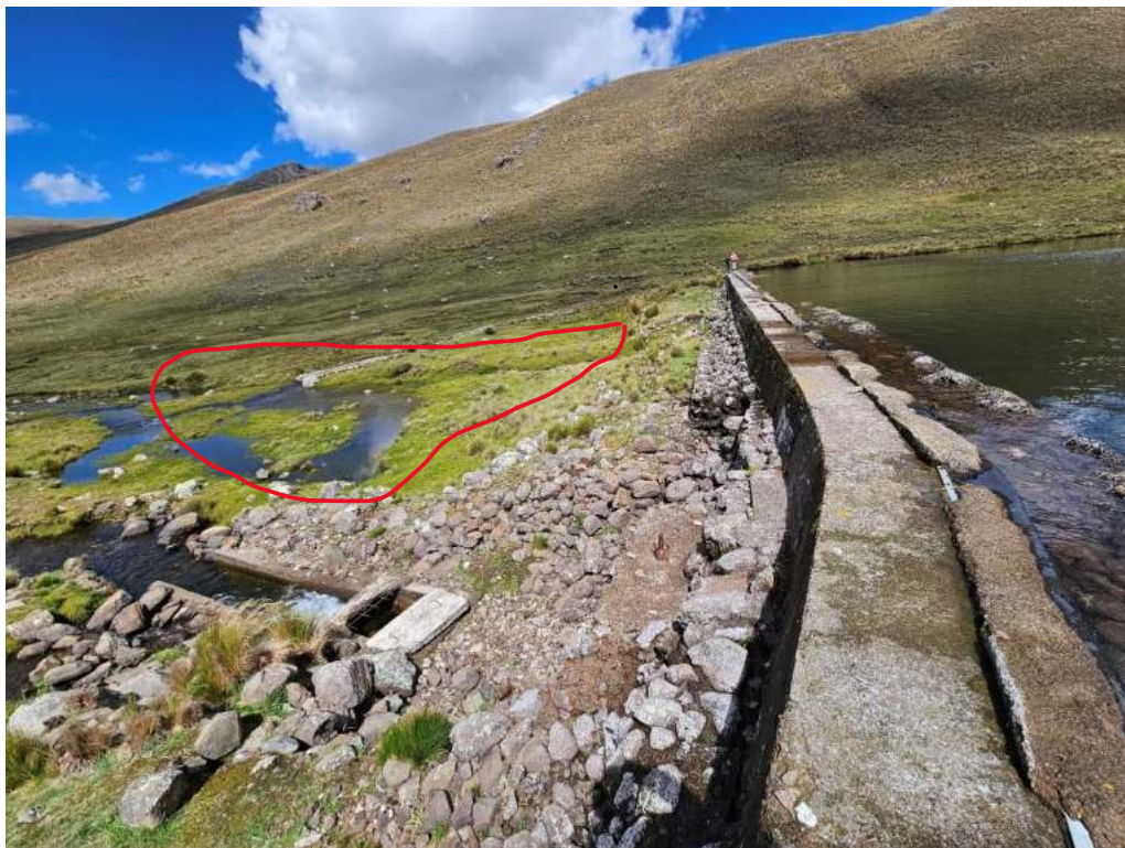
Figura N° 15: Filtraciones aguas abajo de la presa Yanacocha.
