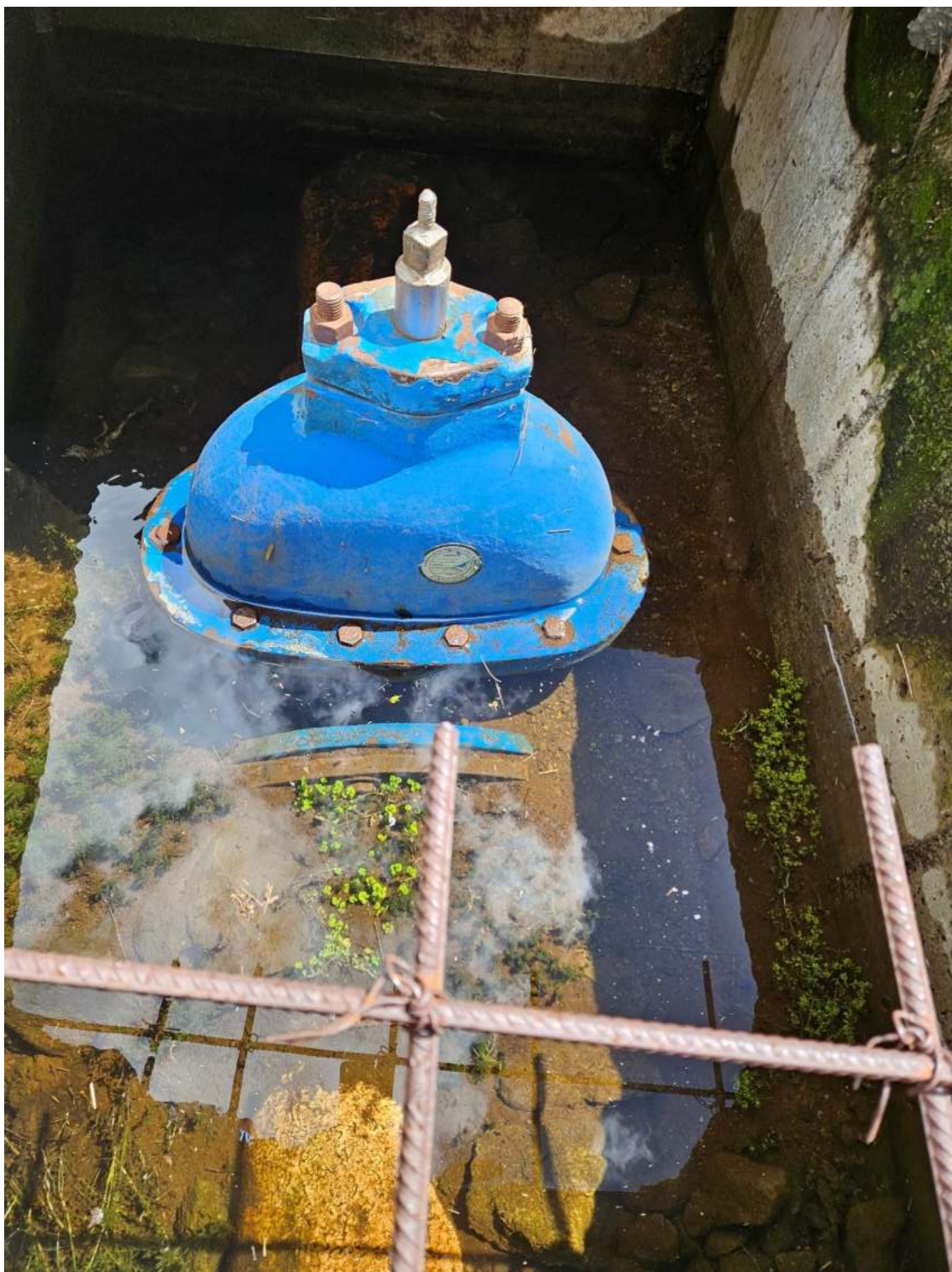
Figura N° 18: Válvula de descarga de la presa Yanacocha.
