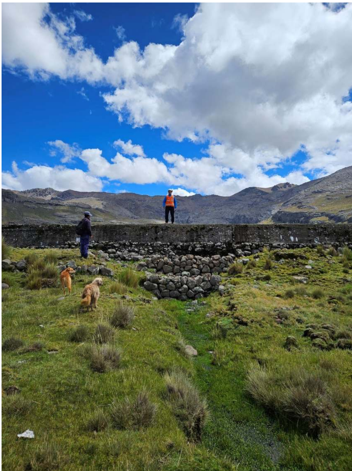
Figura N° 24: Paramento aguas abajo y filtraciones de la presa Yanacocha.
