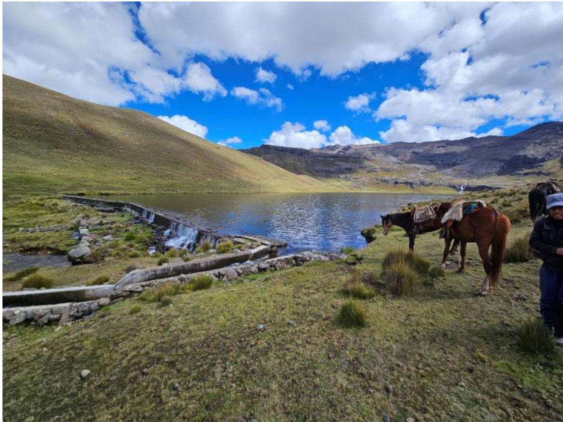
Figura N° 14: Vista general del vaso y aliviadero del estribo izquierdo de la presa Yanacocha.
