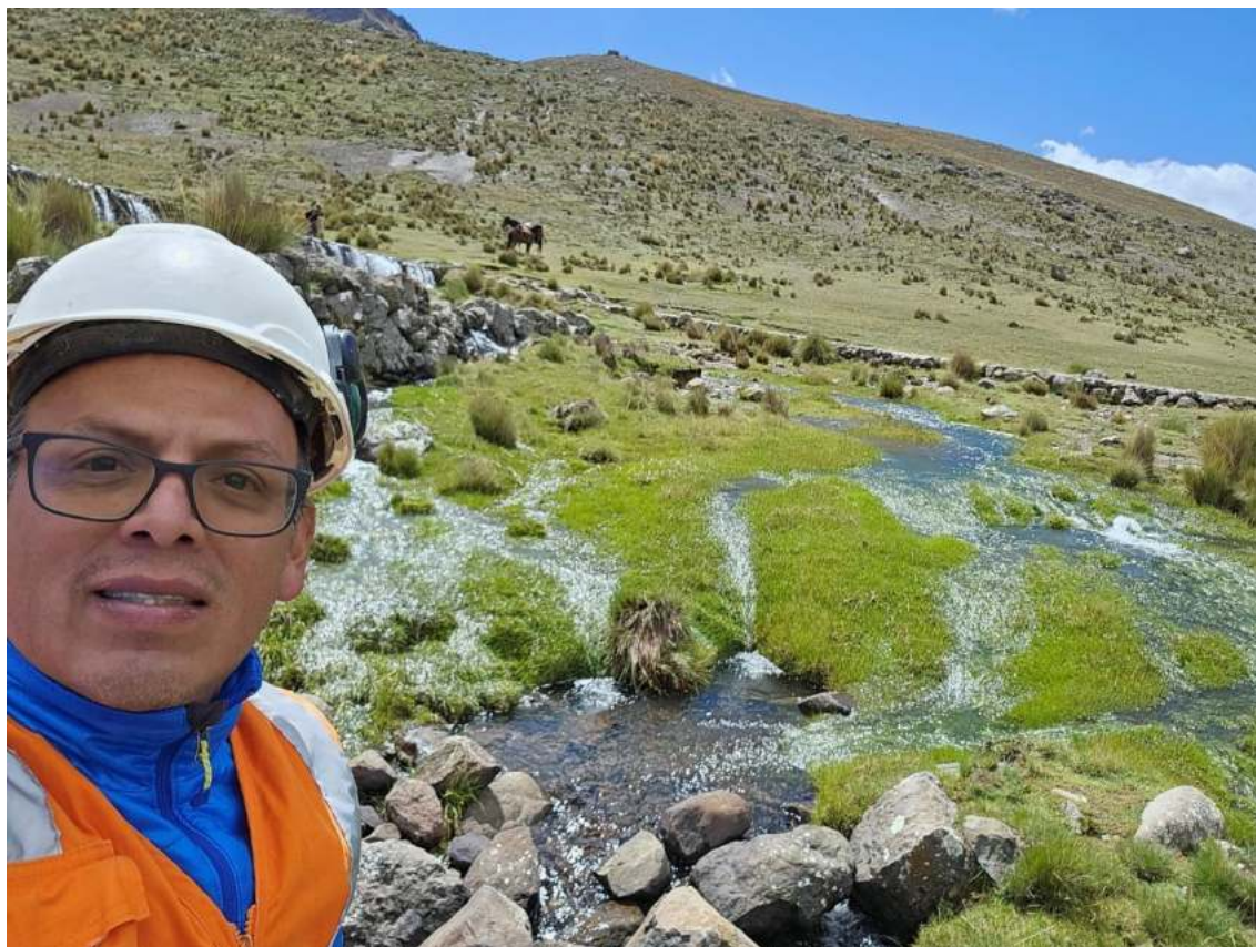
Figura N° 16: Filtración de la presa Yanacocha.
