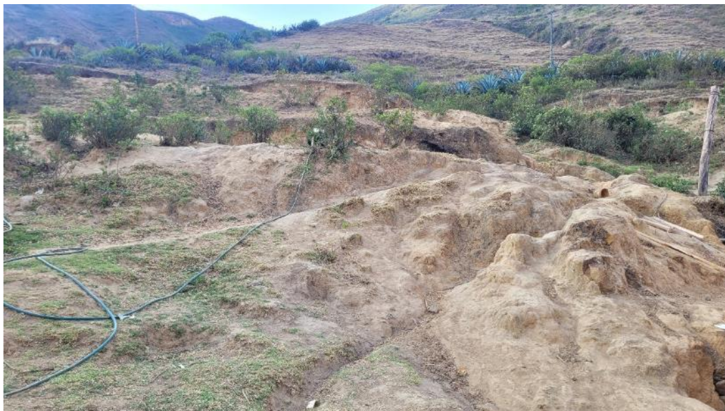
Fotografía 5. Se observa la ladera con escasa cobertura vegetal, lo que favorece la infiltración del agua y la saturación de los terrenos.
