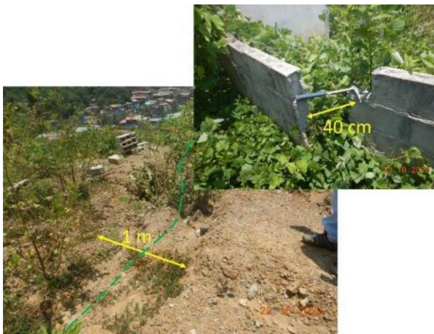
Figura 5. En el cuerpo del deslizamiento quedo derrumbada la construcción de una iglesia evangélica, donde las grietas de hasta 1m de apertura y profundidades visible de hasta 50 cm se encuentran rellenas.
