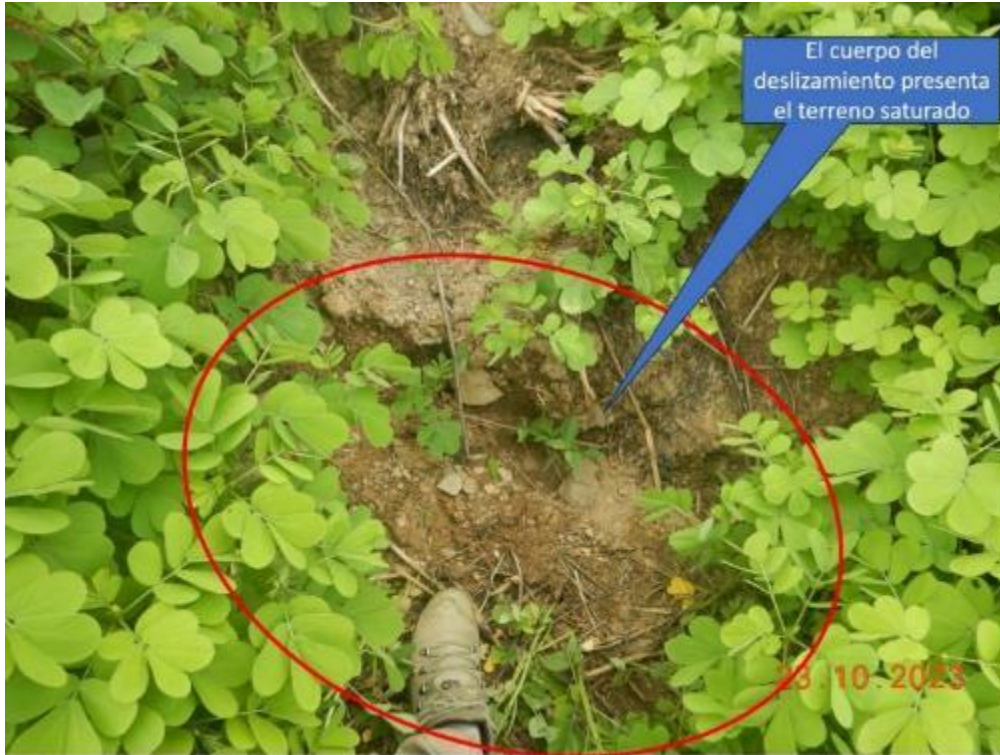
Figura 12. Parte baja del cuerpo deslizado, donde se aprecia los terrenos saturados y con surgencias de aguas.
