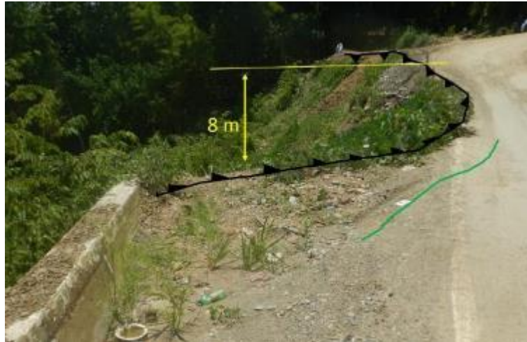
Figura 5. Escarpa principal del deslizamiento con salto de 8 m y una longitud de 48 m, con grietas retrogresivas junto a la vía San Francisco – Santa Rosa que indican su crecimiento.
