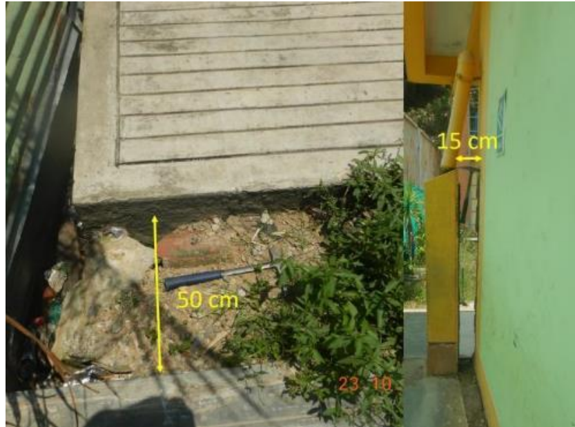
Figura 6. Daños en la Institución Educativa inicial 425-40. Nótese aperturas entre bloques de su construcción de hasta 50 cm.
