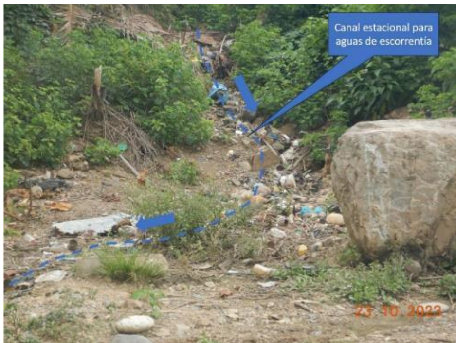
Figura 11. Canal seco en la parte alta del deslizamiento, obstruido por desmontes de residuos sólidos y escombros.
