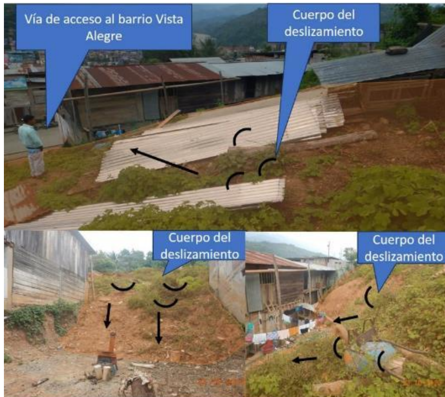
Figura 7. Deslizamiento y viviendas afectadas por este evento.
