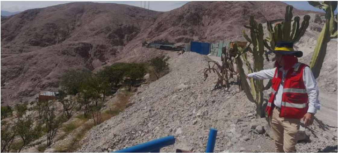
FOTO 21: Vista de los taludes en la zona posterior de las viviendas sin elementos estructurales de contención.
