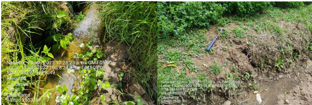
Fotografía 4. Canal de regadío con agua estacionada (izquierda) y canal con agrietamiento producto del proceso de reptación (derecha). Coordenadas: E: 788397; N: 9199049 (izquierda) y E: 788468; N: 9199318 (derecha).
