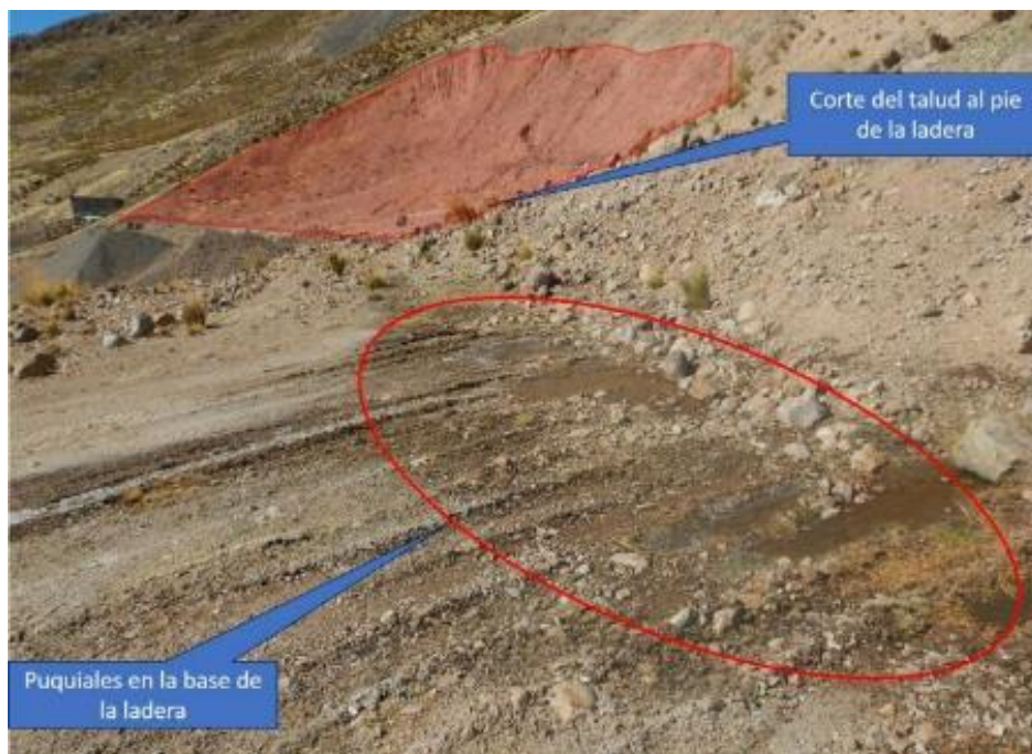
Figura 7. Se aprecia cortes del talud en la base de la ladera y los afloramientos de agua.
