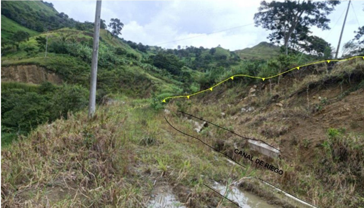
Figura 10. Escape principal del deslizamiento DRA-1, imagen tomada el 28 de marzo del 2023.
