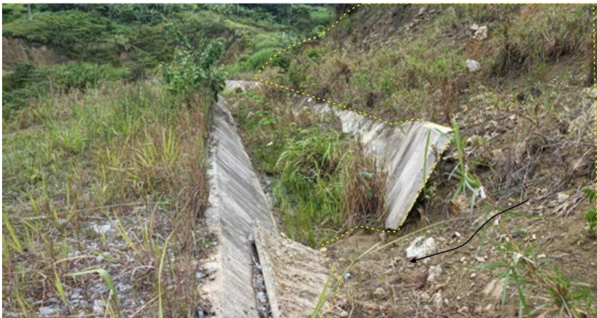
Figura 11. Canal de riego Potrerillo destruido por el deslizamiento DR-1, imagen tomada el 28 de marzo del 2023.
