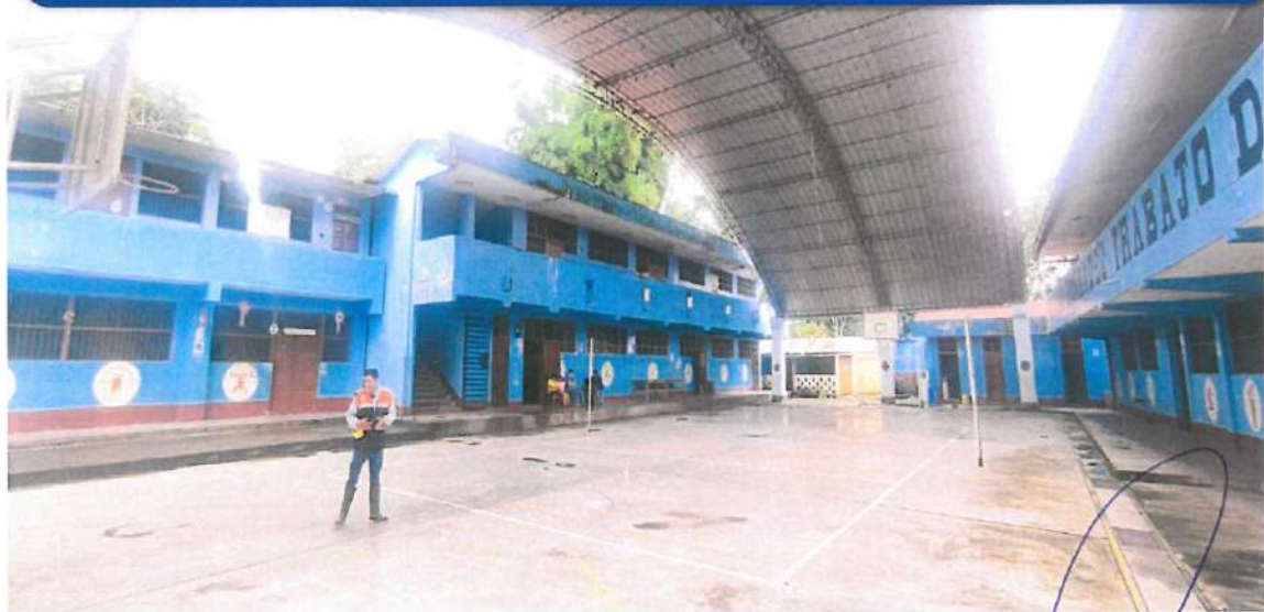
Foto N° 6: Se logra observar moho en la loza deportiva y en los techos, ello es perjudicial en la salud para los alumnos de la institución educativa.
