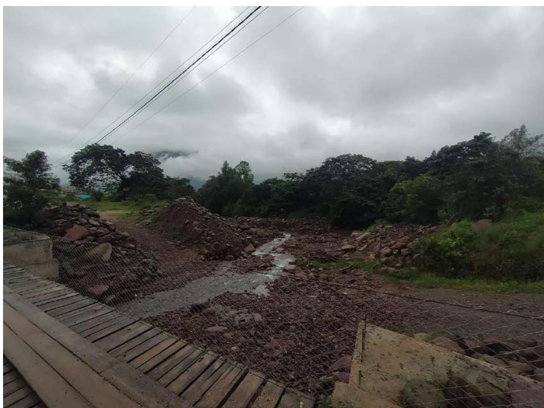
Fotografía 13. Se observa la colmatación del cauce de la quebrada San Luis en las coordenadas UTM, WGS 84, 18s, X:457670.38; Y: 8830212.77.
