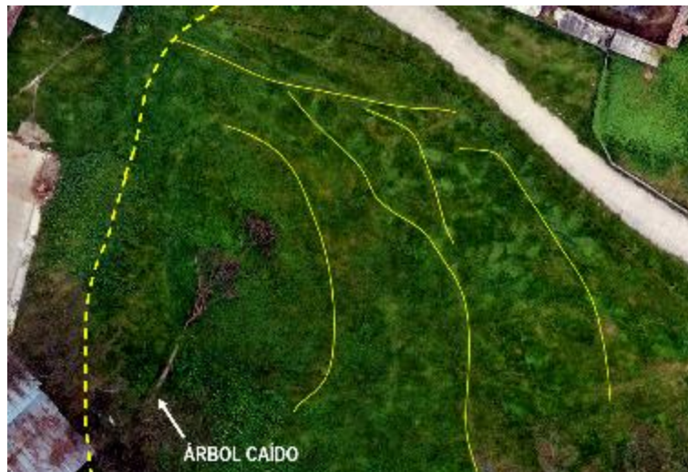
Figura 13. Agrietamientos y árbol caído en la parte sur del deslizamiento.
