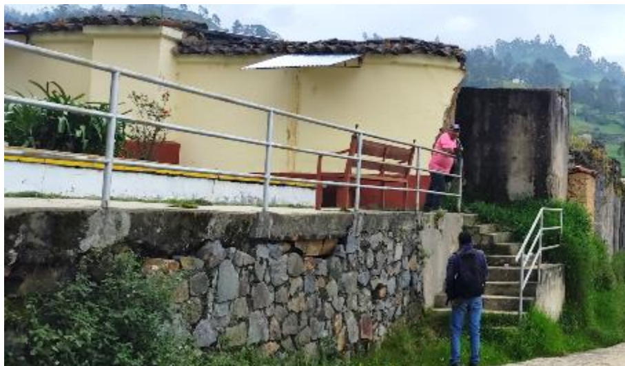
Fotografía 5. Detalle del muro perimetral colapsado en marzo del 2022, en el límite lateral izquierdo del deslizamiento. Ubicación: E: 737754; N: 9225713; Z: 2600.
