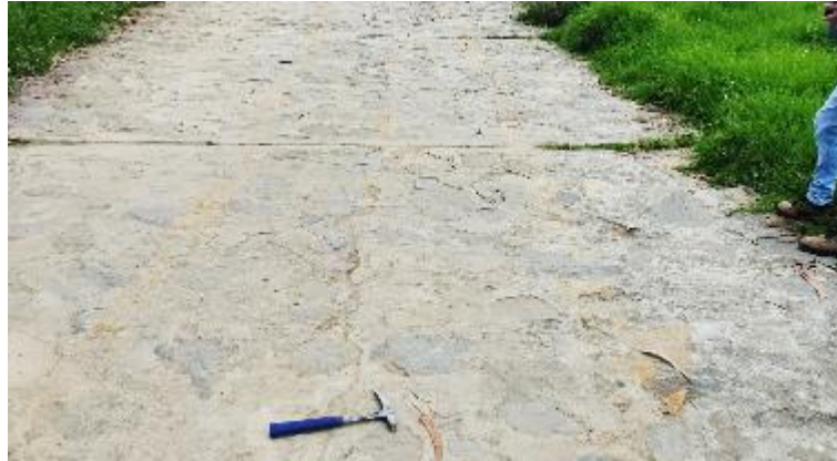
Fotografía 6. Agrietamiento transversal en la vía local que cruza paralelamente al lado sur del cementerio San Juan. Ubicación: E: 737808; N: 9225669; Z: 2595.
