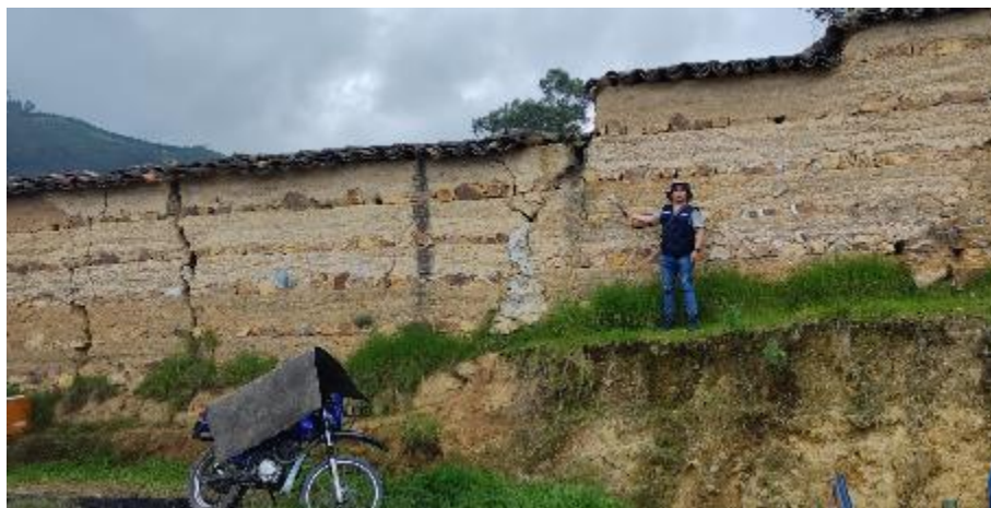
Fotografía 4. Detalle del muro perimetral sur agrietado, se encuentra ubicado al límite lateral derecho del deslizamiento. Ubicación: E: 737913; N: 9225628; Z: 2597.
