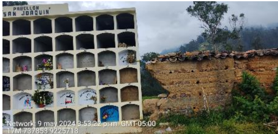
Fotografía 3. Muro perimetral norte afectado por el deslizamiento. Ubicación: E: 737853; N: 9225718; Z: 2603.
