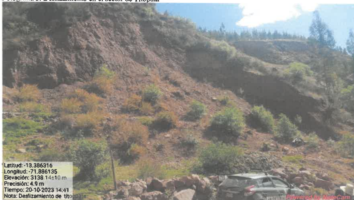
Fotografía 3. Deslizamiento en el sector de Titopata
