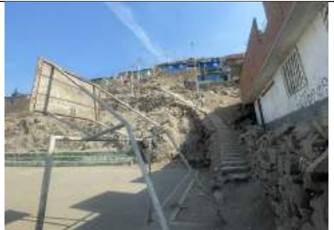
ESCALERA DE ACCESO A LA ASOCIACION CRUZ DE MAYO SOBRE SUELO INESTABLE EN RIESGO DE COLAPSO
