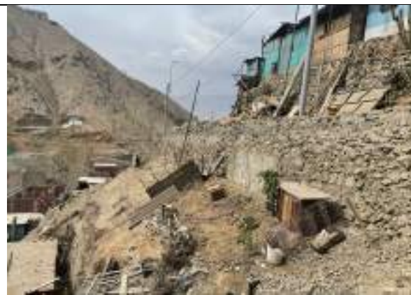
ASOC. LOS EUCALIPTOS – ZONA I VIVIENDA ASENTADAS AL PIE DEL TALUD
