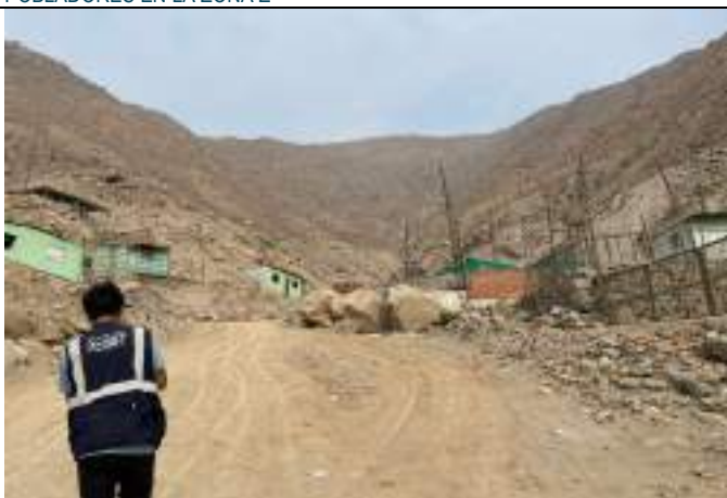
CAUCE DE QUEBRADA, AL LADO VIVIENDAS Y MATERIAL ROCOSO ACARREADO DE ZONAS ALTAS.
