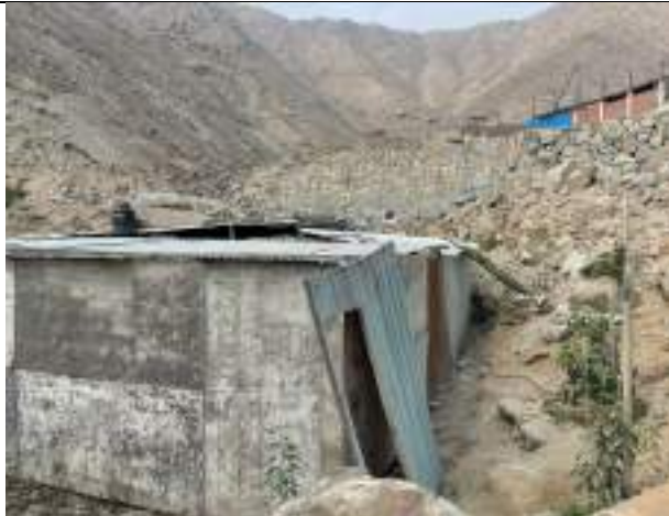
VIVIENDA ASENTADA AL LADO DEL CAUCE DE LA QUEBRADA DE LA ZONA Z.
