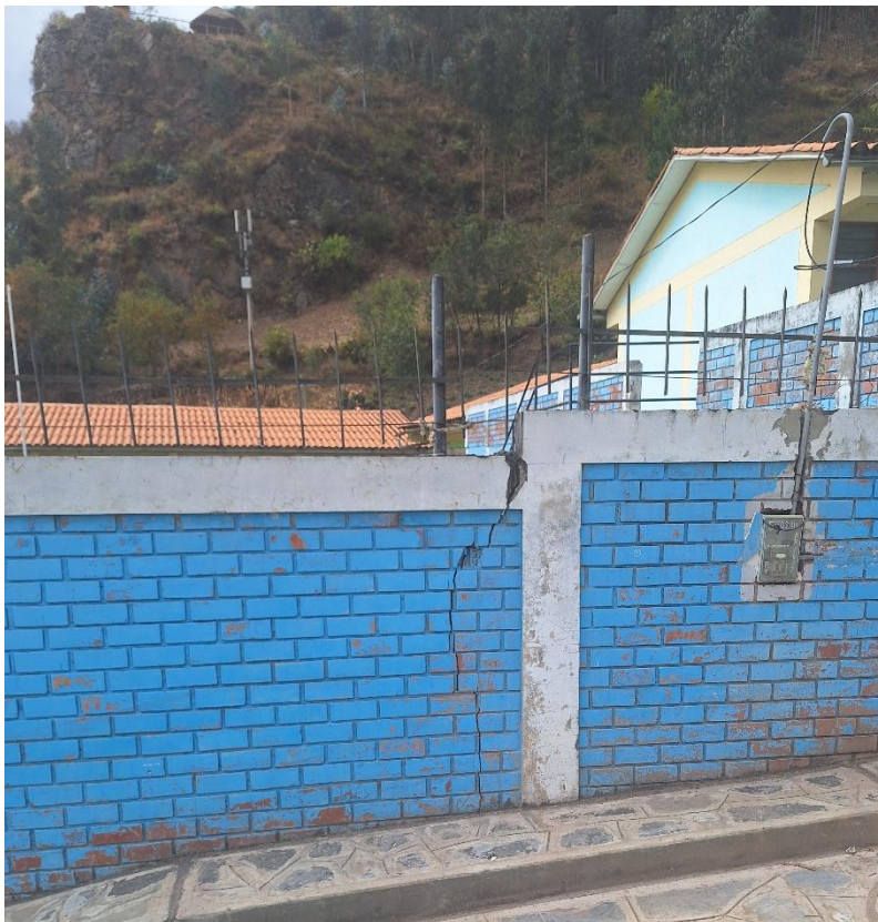
Fotografía 2. Vista de la pared agrietada de la Institución Educativa Inicial del centro poblado Nunupata.
