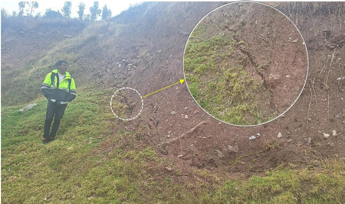
Figura 5. Vista de agrietamientos longitudinales producidos en la base del escarpe del deslizamiento D3.
