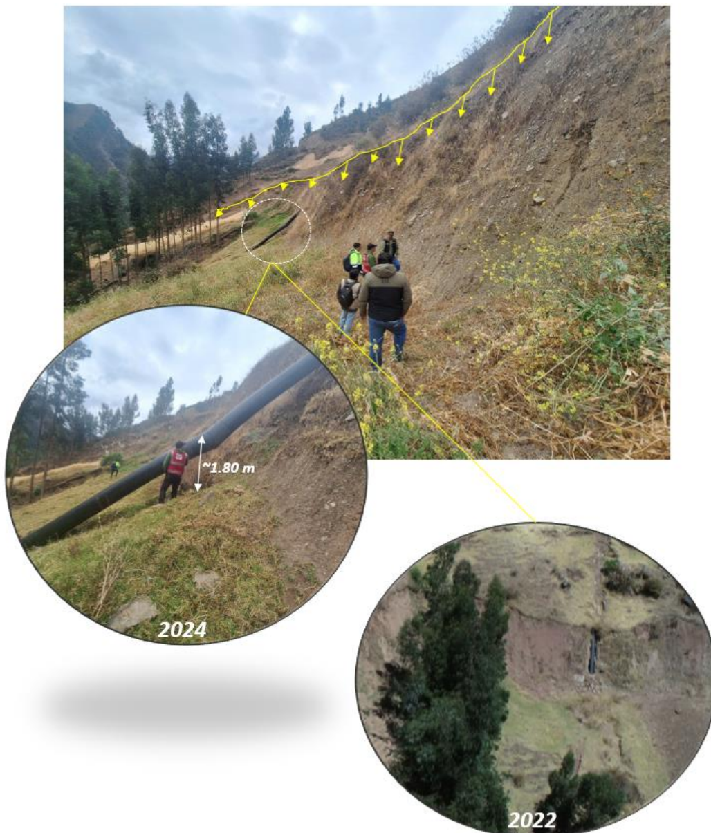
Figura 4. Escarpe del deslizamiento D3, se observa movimientos verticales dejando expuesto el tubo colector de agua. Se puede ver que este tubo el año 2022 estaba enterrado en el subsuelo, pero en la actualidad está expuesto. La línea amarilla muestra el escarpe del deslizamiento y la línea punteada de color blanco muestra el último movimiento vertical de 1.80 m.
