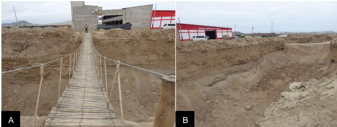
Figura 6. A. Puente colgante de 18 m de longitud y una altura 6m, afectado durante el paso del flujo de lodo en marzo del 2023; 10 m agua arriba se produjo un desborde que discurrió por la vía de acceso. B. Aguas abajo del puente, se observa el cauce en proceso de limpieza y una vía improvisada e informal que cruza el cauce, obstruyendo la quebrada. Tomado de Ingemmet 2023.
