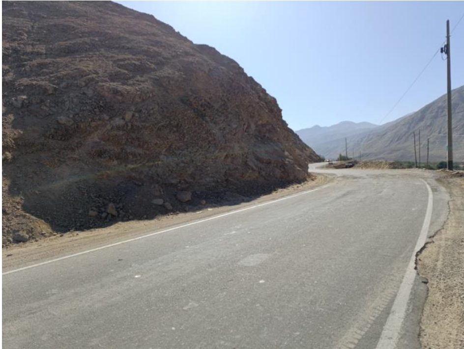
Fotografía 5. Tramo caserío San Andrés-Chaparra. Se observa rocas intrusivas medianamente a muy fracturado, se aprecian bloques sueltos, angulosos, de hasta 0.7 m aprox., los cuales cayeron y obstruyeron la vía por el sismo.
