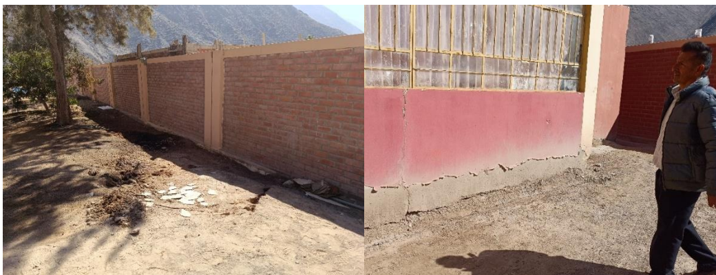
Figura 15. Sector IE Nuestra Señora María del Pilar. Se observa grietas en infraestructura y hundimientos, ocurridas durante el sismo.
