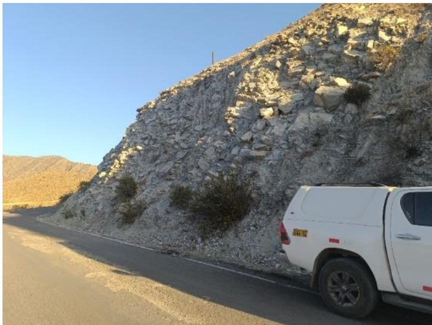
Fotografía 2. Sector tramo carretero Sifuentes - Tierras Blancas, bajada Quichaca a la altura de la quebrada Rancaminas. Se observa talud rocoso medianamente a muy fracturado, conformado por rocas intrusivas, además de bloques sueltos, angulosos, de hasta 1 m aprox., los cuales cayeron y obstruyeron la vía por el sismo.
