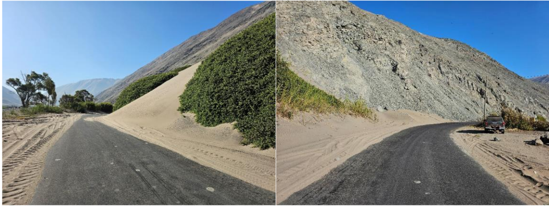
Figura 12. Muestra la carretera de Secocha a Ocoña, zona susceptible (Apenamiento) a derrumbes, que afectan a la carretera.
