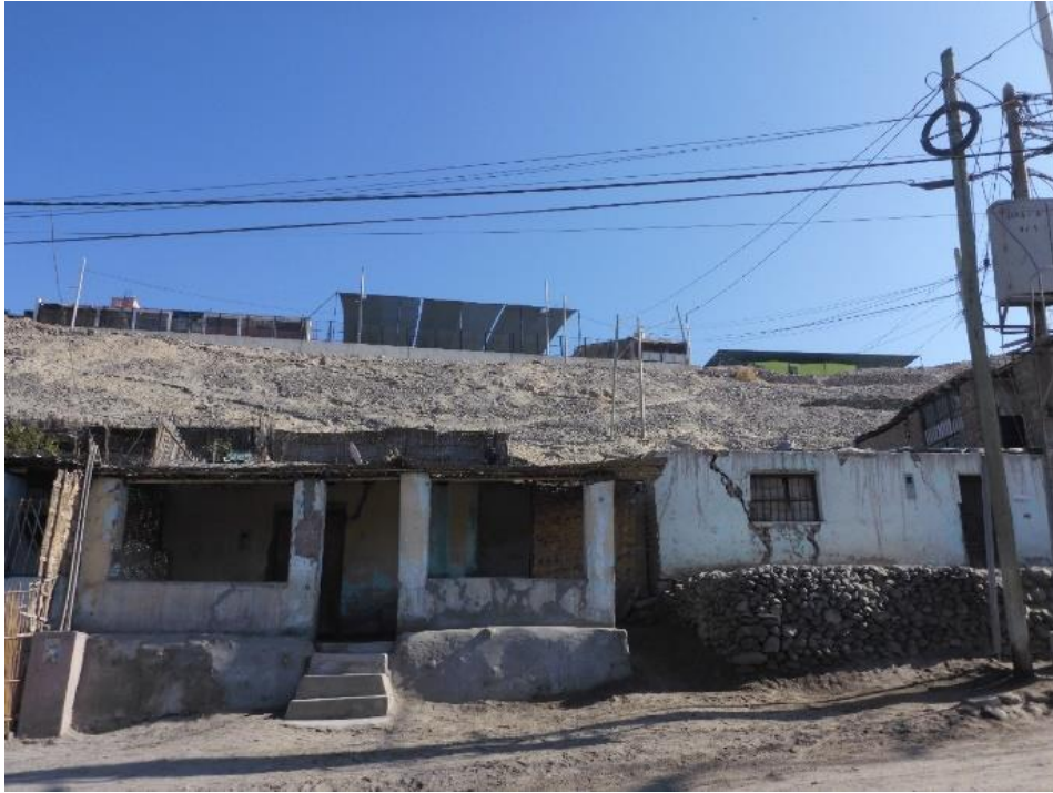
Fotografía 21. La A.H. Sacramento se observa viviendas afectadas por el sismo del 26 de junio.
