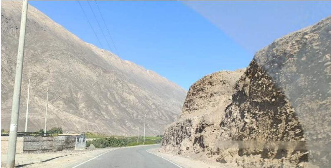
Fotografía 9. Tramo carretero Huancalpa – Achanizo, sector Comepan. Se observa un talud rocoso moderadamente a muy fracturado, conformado por andesitas, además de bloques sueltos, angulosos, de hasta 0.5 m, los cuales cayeron y obstruyeron la vía por el sismo.
