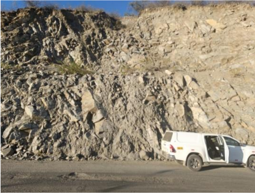
Fotografía 1. Sector tramo carretero Sifuentes - Tierras Blancas, bajada Quichaca. Se observa un talud conformado por rocas intrusivas medianamente a muy fracturadas, que generan bloques sueltos, angulosos, de hasta 0.5 m aprox., los cuales cayeron y obstruyeron la vía por el sismo.
