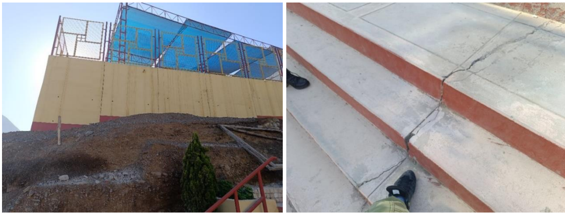
Figura 14. Sector centro deportivo de Achanizo. Se observa separación de paños de infraestructura deportiva, ocurrida durante el sismo.
