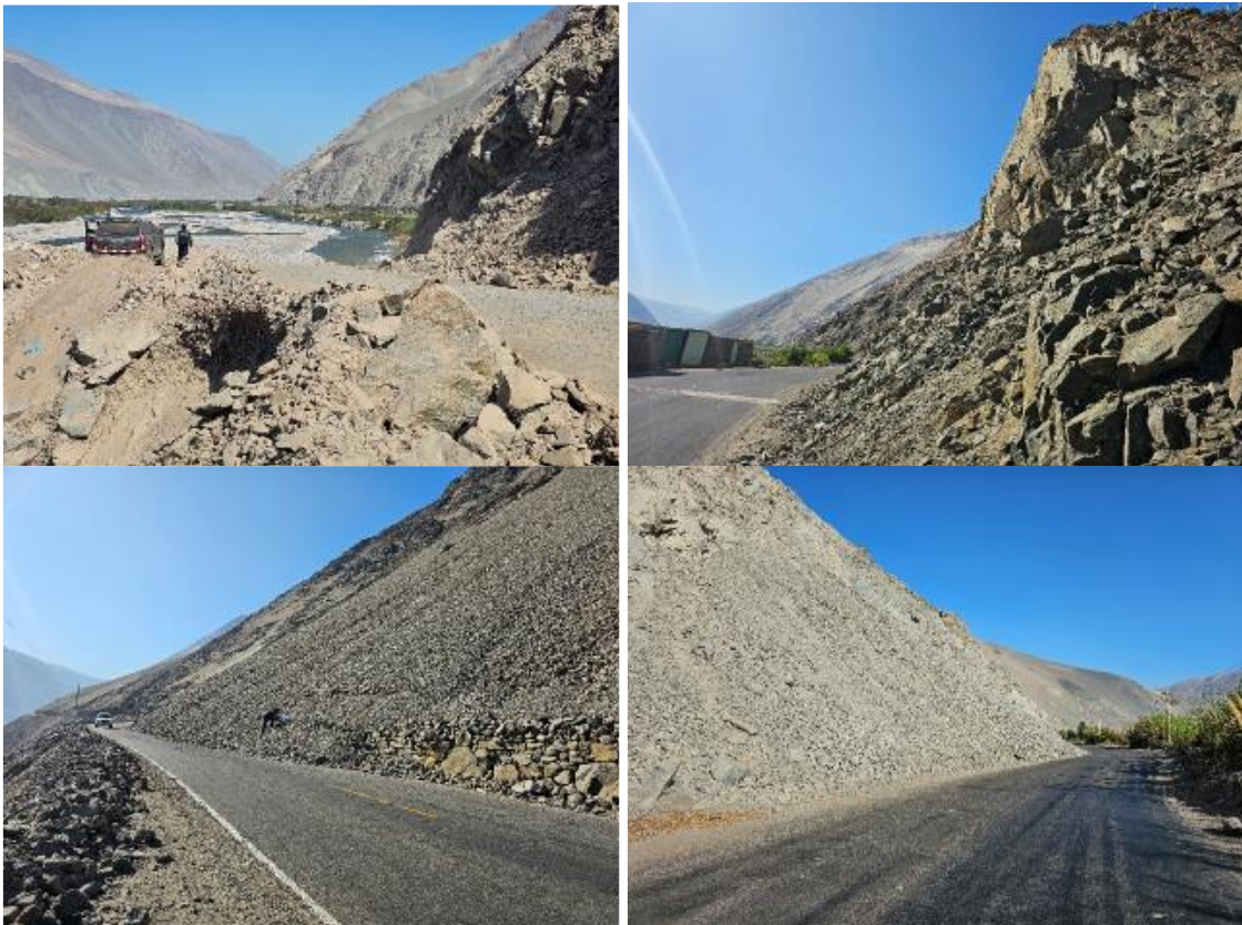
Figura 11. Carretera de Ocoña-Secocho, afectada por caídas de rocas, evento activado por el sismo ocurrido en Yauca. Se apreció que el macizo rocoso se encuentra medianamente a muy fracturado.
