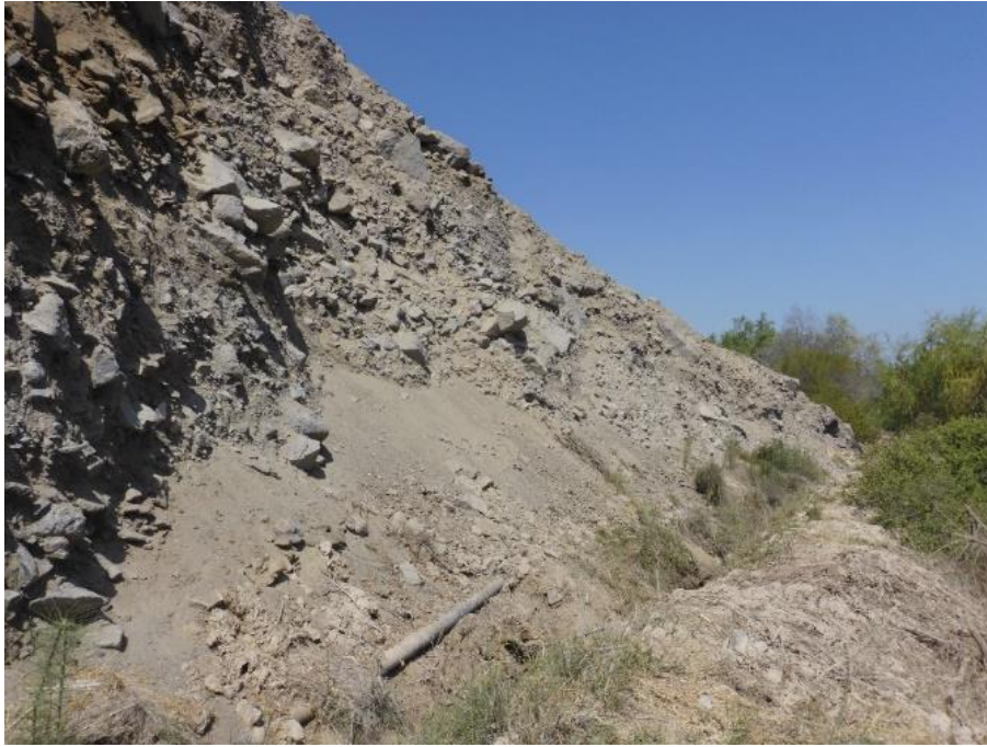
Fotografía 16. El sector de Aragelí afectado por derrumbes y caídas de rocas, generaron daños en el canal de agua potable el poblado de Jaqui. Estos procesos se generaron en terrenos con pendiente fuerte y material inconsolidado, afectando al canal 1 km.
