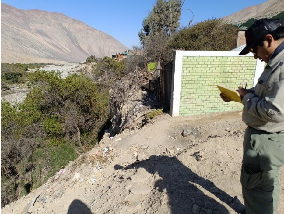
Fotografía 11. Sector IE Simón Bolívar. Se observa inclinación de muros aledaños a zona de ladera (terracea aluvial), ocurridas durante el sismo.
