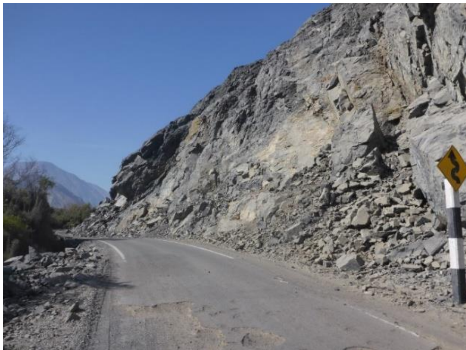
Fotografía 19. El sector Peña Negra afectado por caídas de rocas y derrumbes que generaron daños en la carretera de acceso a Jaqui en un tramo de hasta 500 m. Estos procesos se generaron en terrenos con pendiente muy fuerte del terreno y substrato rocoso fracturado y meteorizado.
