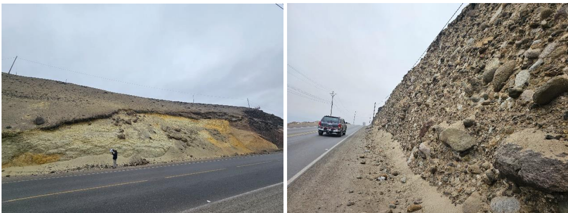
Figura 3. Borde de la carretera Panamericana, puente Chala hacia Aguadita, se evidencian caída de rocas con diámetro menor a 1 m, de cortes de carretera con pendientes entre 50° a 80°.
