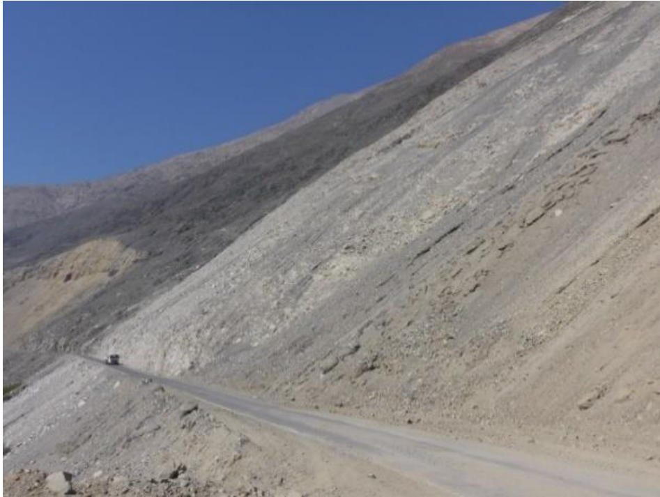
Fotografía 18. El sector Reynoso-Anexo San Luis/ Km 48+700 fue afectado por caídas de rocas y derrumbes que generaron daños de hasta 600 m en la carretera de acceso a Jaqui.
