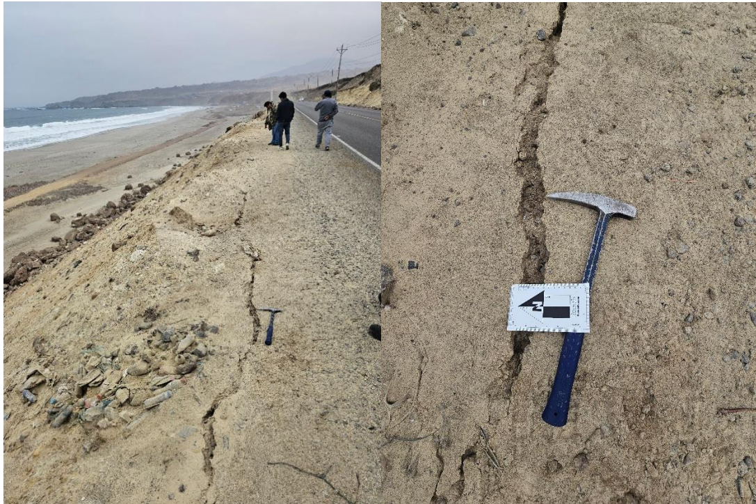
Figura 4. Borde de la carretera Panamericana, puente Chala hacia Aguadita (Km 76). Se evidencia grietas de hasta 10 cm al borde de la carretera, a lo largo de 50 m.
