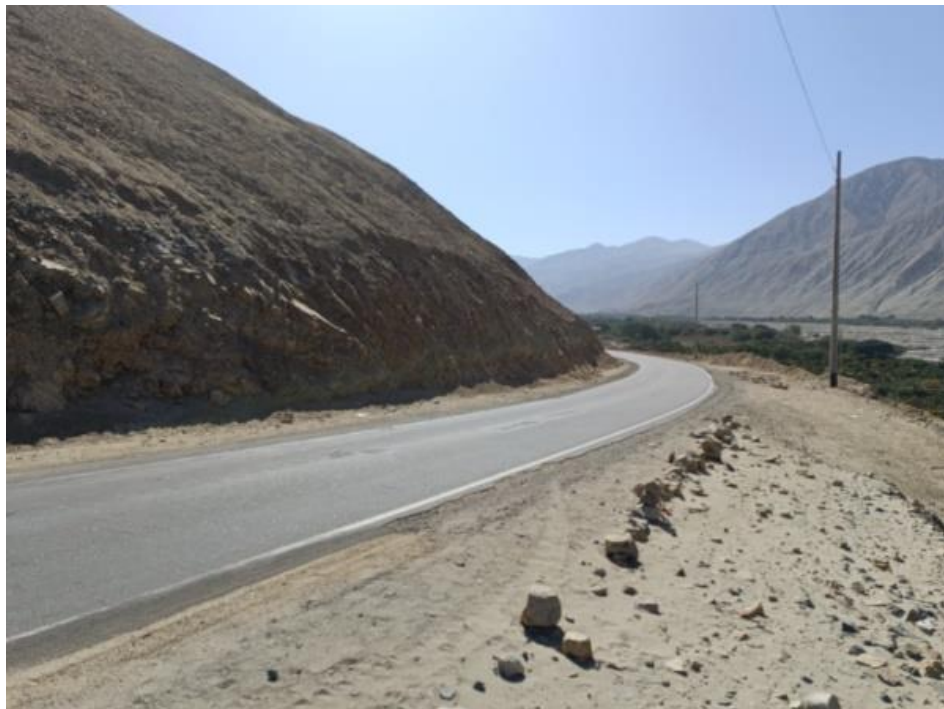
Fotografía 6. Tramo caserío San Andrés-Chaparra. Se observa un talud rocoso muy fracturado, conformado por rocas intrusivas, además de bloques sueltos, angulosos, de hasta 0.7 m, los cuales cayeron y obstruyeron la vía por el sismo.
