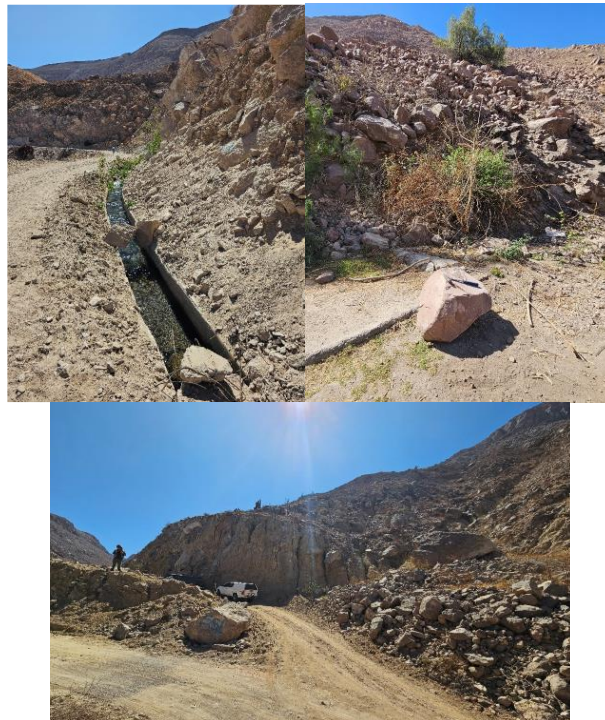
Figura 9. Muestra la carretera de Caravelí a Chuñuño, que fue afectada por caída de rocas debido al sismo ocurrido en Yauca. Se puede evidenciar que el macizo rocoso se encuentra fracturado.
