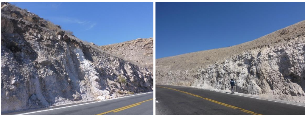
Figura 16. La Carretera Nasca-Abancay Km 42+800 y 25+800; fue afectada por caídas de rocas y derrumbes que generaron daños de hasta 30 y 100 m.
