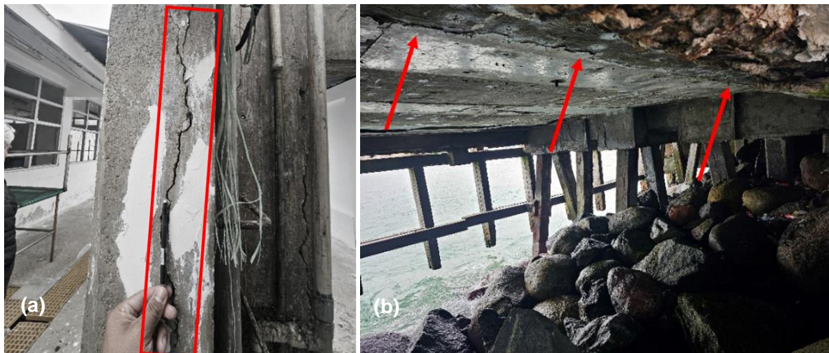
Figura 8. Evaluación de daños en el puerto de Chala, las estructuras de concreto del puerto en si sitúan sobre el Batolito de la Costa, se observó fracturas y agrietamientos centimetradas, a) columna del tanque de agua con fracturas y b) techo del puerto con fracturas en el sector intermedio del puerto.
