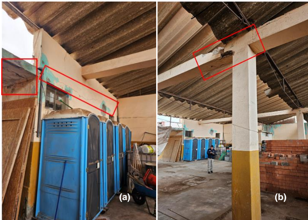
Figura 7. Ex mercado central de Chala, donde se visualizan los agrietamientos entre la unión de estructuras de concretos limitados con líneas de color rojo.
