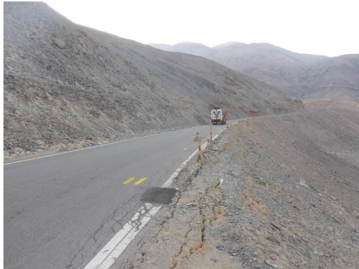
Fotografía 20. Procesos de caídas de rocas, derrumbes y asentamientos en la carretera hacia Huari fue afectada en un tramo de hasta 50 m. Estos procesos se generaron en terrenos con pendiente muy fuerte del terreno y substrato rocoso fracturado y meteorizado.
