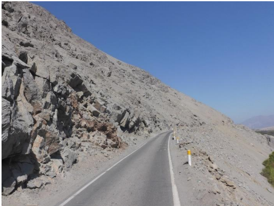
Fotografía 17. El sector Huayanas, Km 36-Carretera a Cora Cora, afectado por caída de rocas y derrumbes que generaron daños por 1 km en la carretera de acceso a Jaqui.
