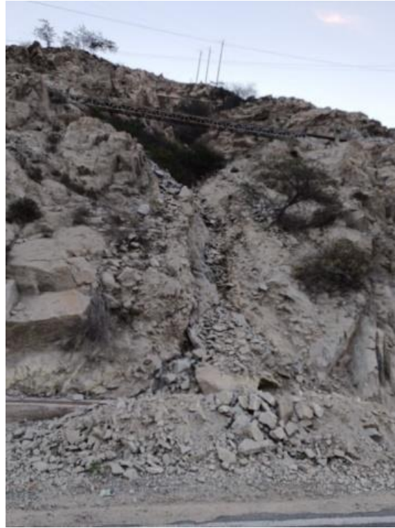
Fotografía 3. Tramo carretero Quichaca - Chaparra, sector Chiuchine. Se observa un talud rocoso medianamente a muy fracturado, conformado por rocas intrusivas, además de bloques sueltos, angulosos, de hasta 1 m aprox., los cuales cayeron y obstruyeron la vía por el sismo.
