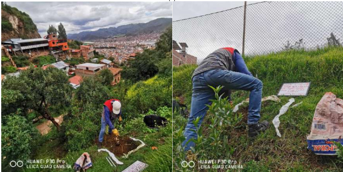
Fotografía 18: Calicata C-SP 05 para la estabilidad de taludes del perfil D-D' Fuente: Equipo técnico.
