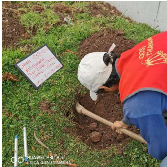
Fotografía 14: Excavación de calicata CSP-01 para la extracción de muestra para los ensayos de EMS para la estabilidad de taludes del perfil B-B' Fuente: Equipo técnico.
