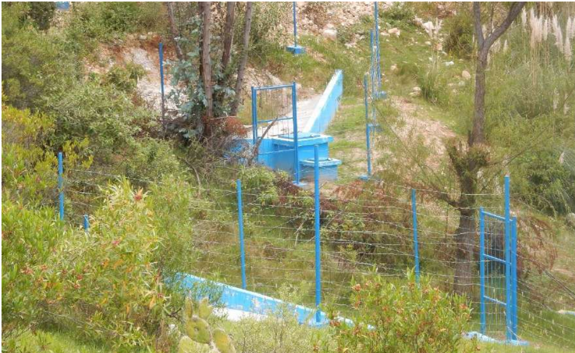
Fotografía 04. Captaciones de agua potable
