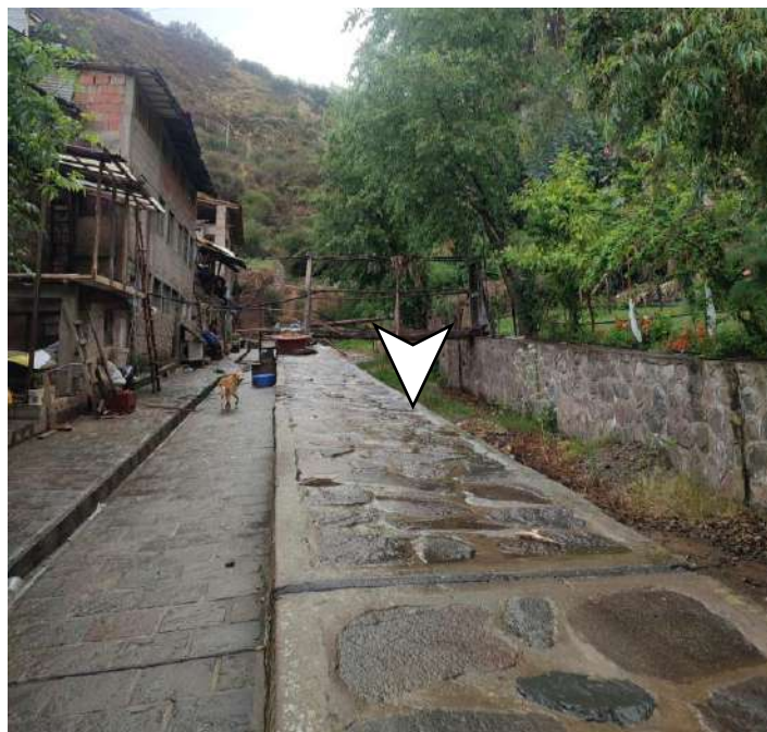
Fotografía 2:Relieves con inclinación de 5° a 10° que se observan en las vías asfaltadas. Fuente: Fotografía propia.
