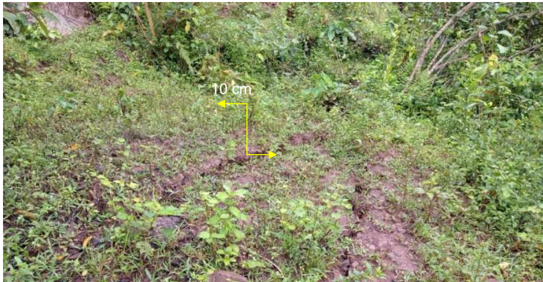
Foto N° 7. Grietas de tensión de 10 cm de abertura-2023
