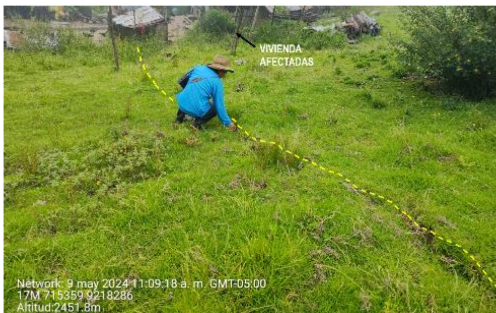
Figura 12. Agrietamiento del límite lateral izquierdo que afecta a una vivienda.
