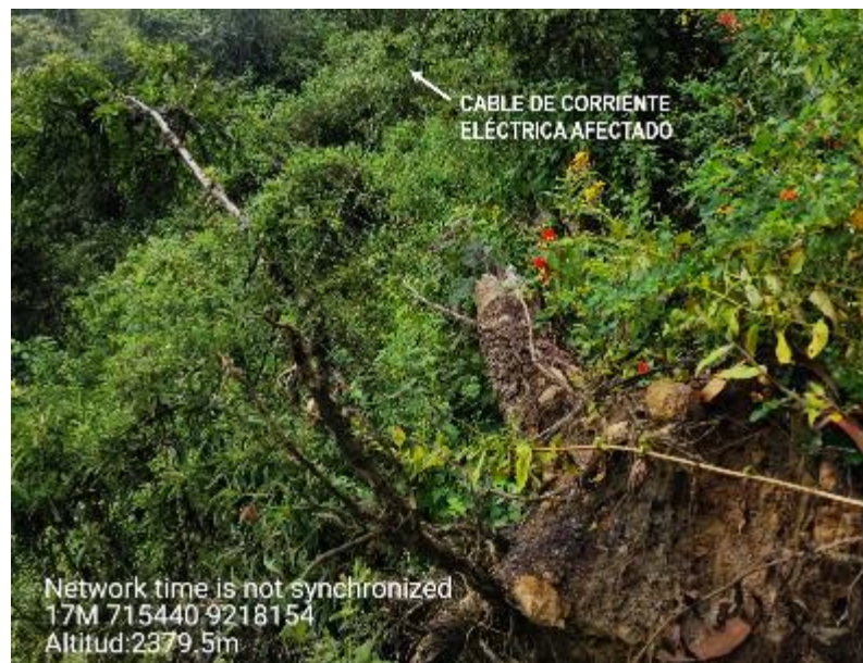
Figura 14. Cable de corriente eléctrica afectado por la caída de un árbol producto del deslizamiento, ubicado en la parte baja del cuerpo del mismo.
