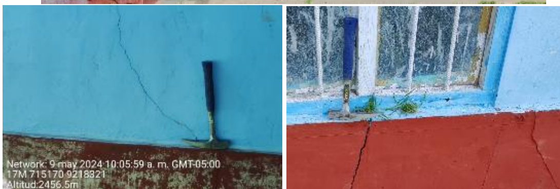
Fotografía 4. Vista de la IE 821381 y algunos agrietamientos en su infraestructura debido a la tracción de suelos producto del lento movimiento de los suelos.
