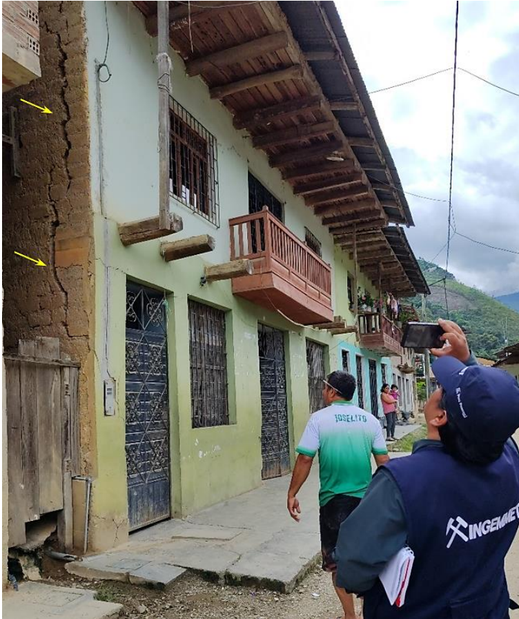
Figura 7. Vivienda con agrietamiento de longitud 3.2 m y ancho 17 cm. Coordenadas UTM WGS84 17M. 777505, 9334782
