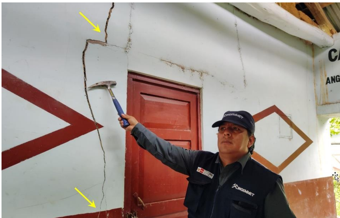
Figura 11. Vivienda afectada con grietas en la pared, con longitud de 1.20 m y ancho de 1 a 2 cm. Coordenadas UTM WGS84 17M. 777493, 9334805.
