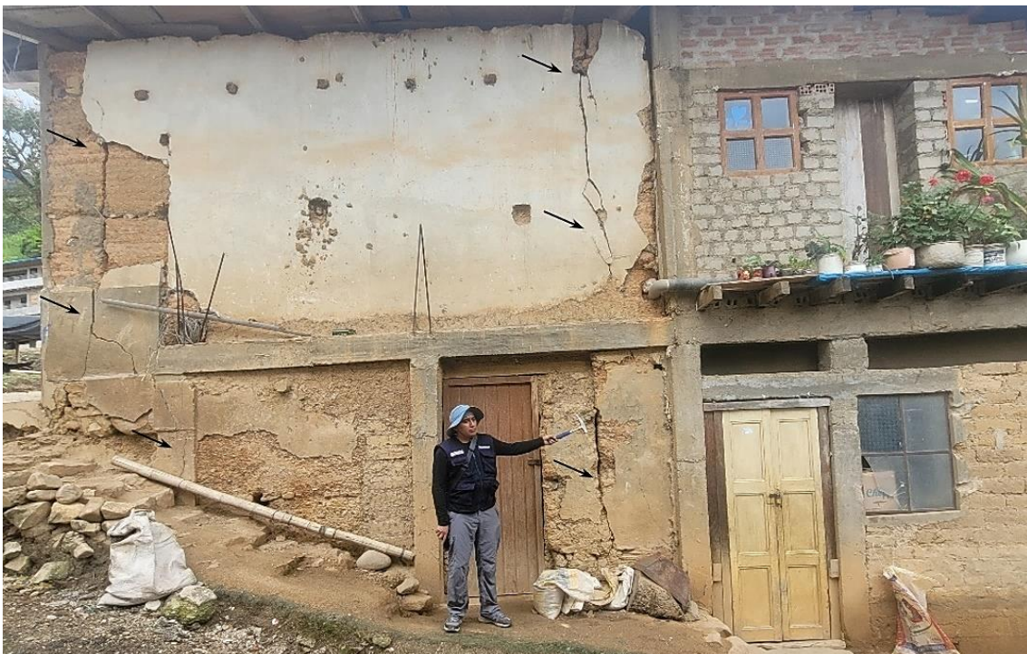
Figura 8. Pared de fachada de vivienda afectada con grietas con longitud 1 a 2 m y ancho de 1 a 2 cm. Coordenadas UTM WGS84 17M. 777447, 9334685.
