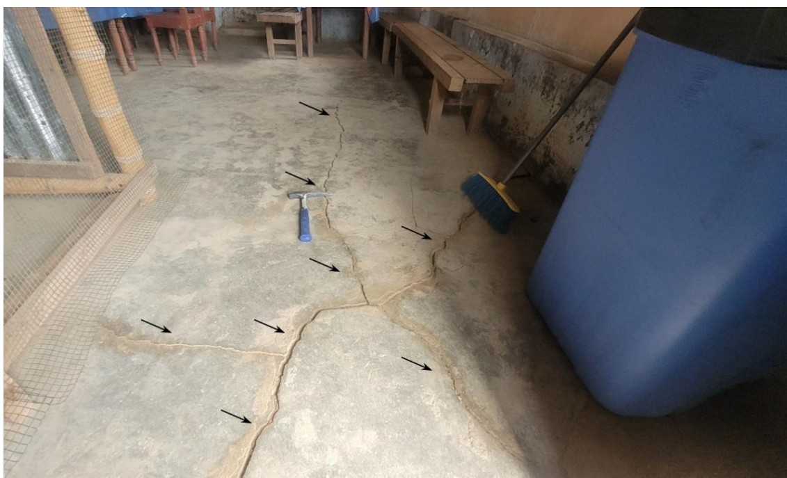
Figura 12. Piso de vivienda que muestra grietas con longitud de 2 a 3 m y ancho de 1 a 2.5 cm. Coordenadas UTM WGS84 17M. 777471, 9334816.
