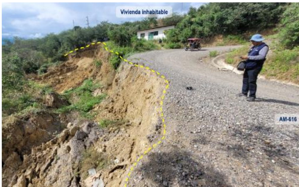
Figura 14. Escarpe principal del deslizamiento D-1 durante las actividades en campo del 2023. Ubicación: E: 801667; N: 9355703.
