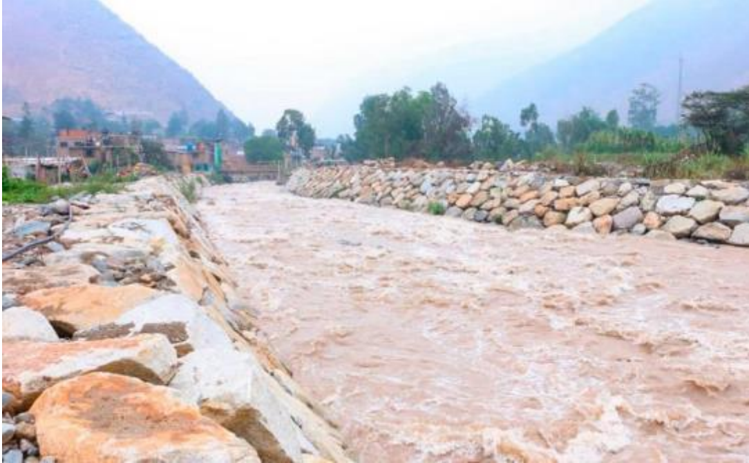
Fotografía 6. Ejemplo de defensa ribereña con roca al volteo.
