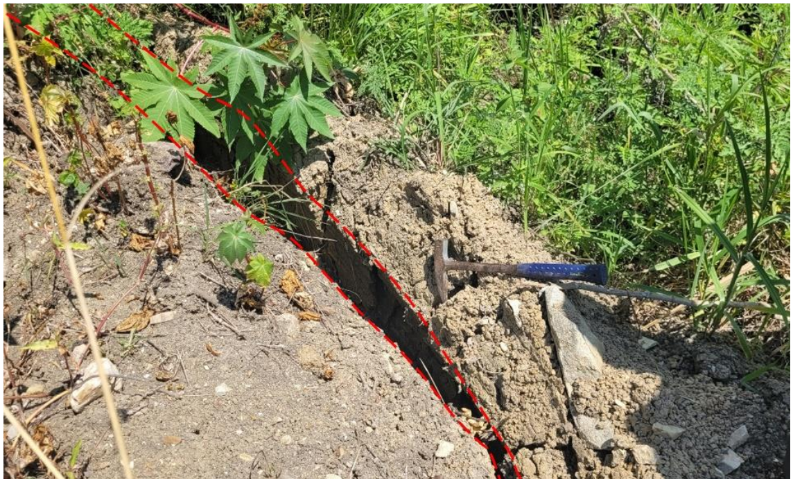
Figura 8. Agrietamiento de 20 m de longitud y ancho promedio de 15 cm. (Coordenadas UTM WS-84 -17S, Norte: 9336398 – Este: 734178).
