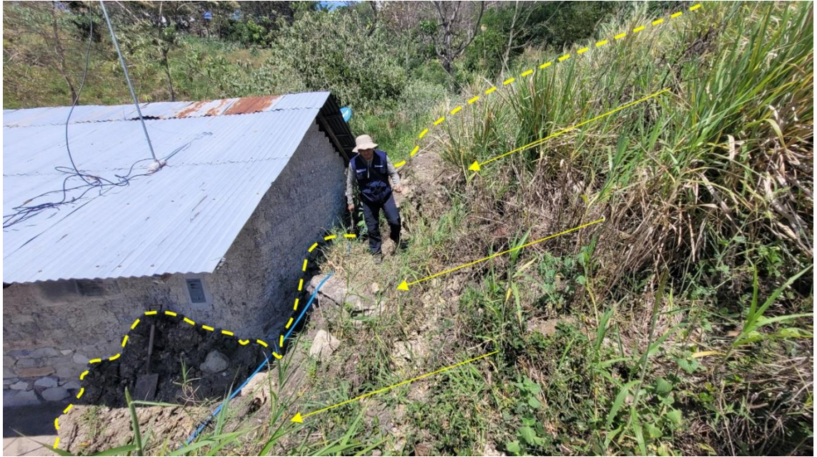
Figura 11. Material transportado por el deslizamiento, origina empuje en vivienda, causando agrietamiento de paredes. (Coordenadas UTM WS-84 -17S, Norte: 9336381 – Este: 734303).
