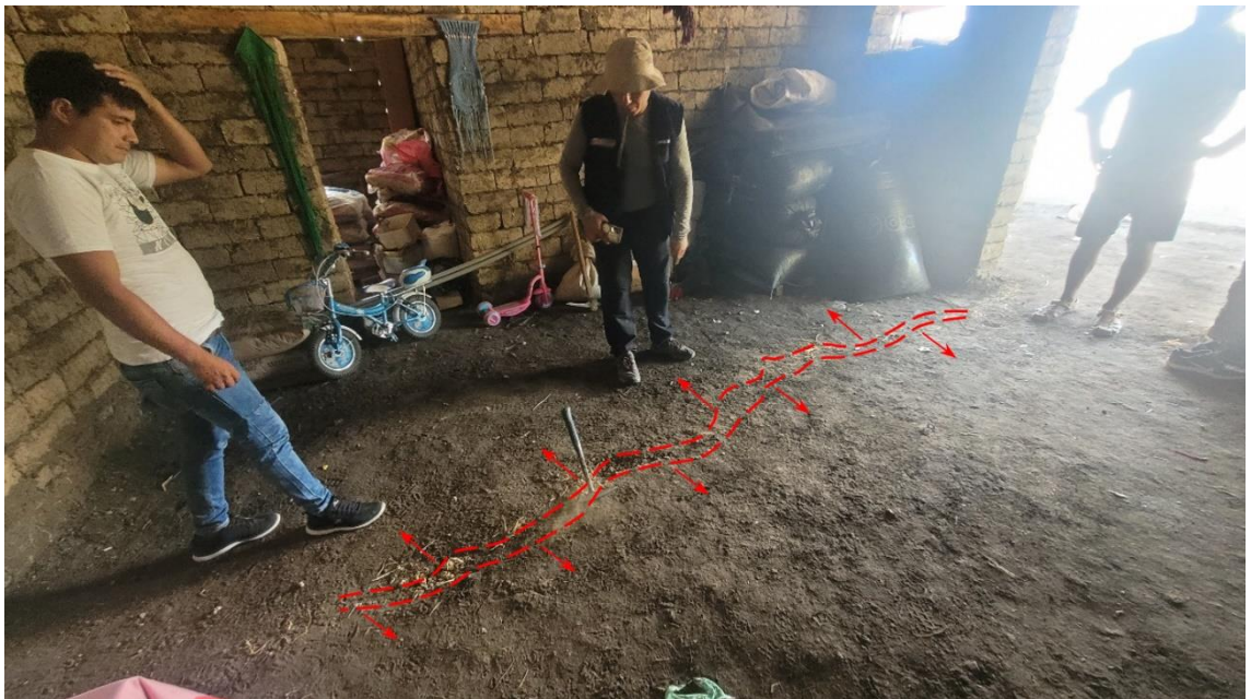
Figura 12. Agrietamiento en el piso de 3 m de largo y 10 cm de ancho. (Coordenadas UTM WS-84 -17S, Norte: 9336553 – Este: 734345).
