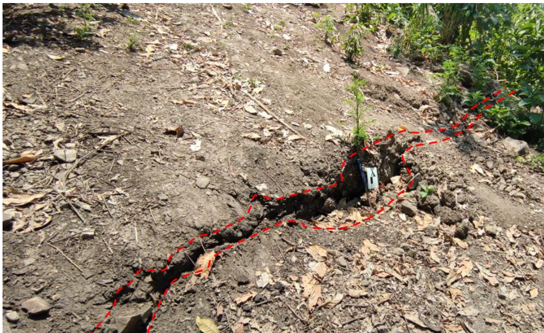
Figura 9. Se observa un agrietamiento fuera del cuerpo de deslizamiento con longitud de 86 m y un ancho variable de 5 cm. a 15 cm, con desplazamiento vertical hasta de 20 cm. (Coordenadas UTM WS-84 -17S, Norte: 9336582– Este: 734264).
