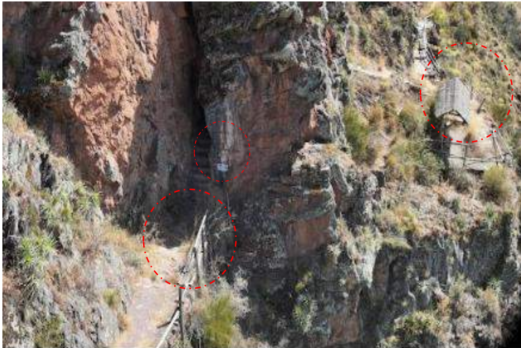
Figura 80. Camino, barandas y señaléticas expuestas al peligro alto en el sector del Túnel 01.
