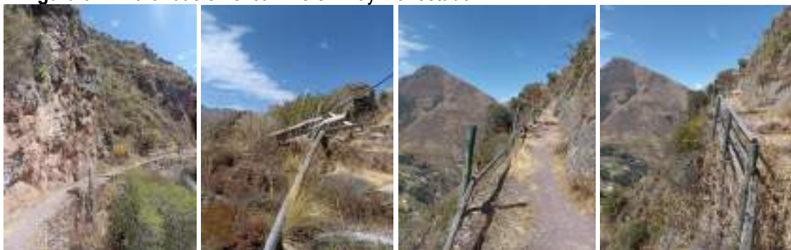
Figura 91. Barandas en el camino en muy mal estado.
