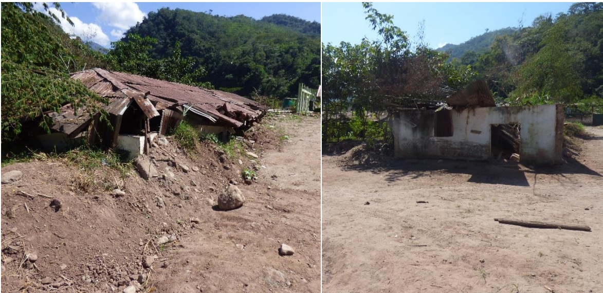
Figura 12. Viviendas destruidas y abandonadas, posterior a los eventos del 2009.
