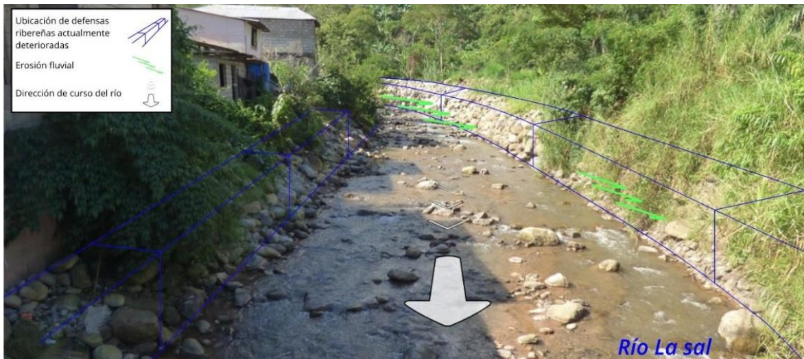
Figura 10. Río La Sal con defensas ribereñas tipo enrocado deterioradas por erosión fluvial. Tomada de (Núñez & Albinez, 2018).
