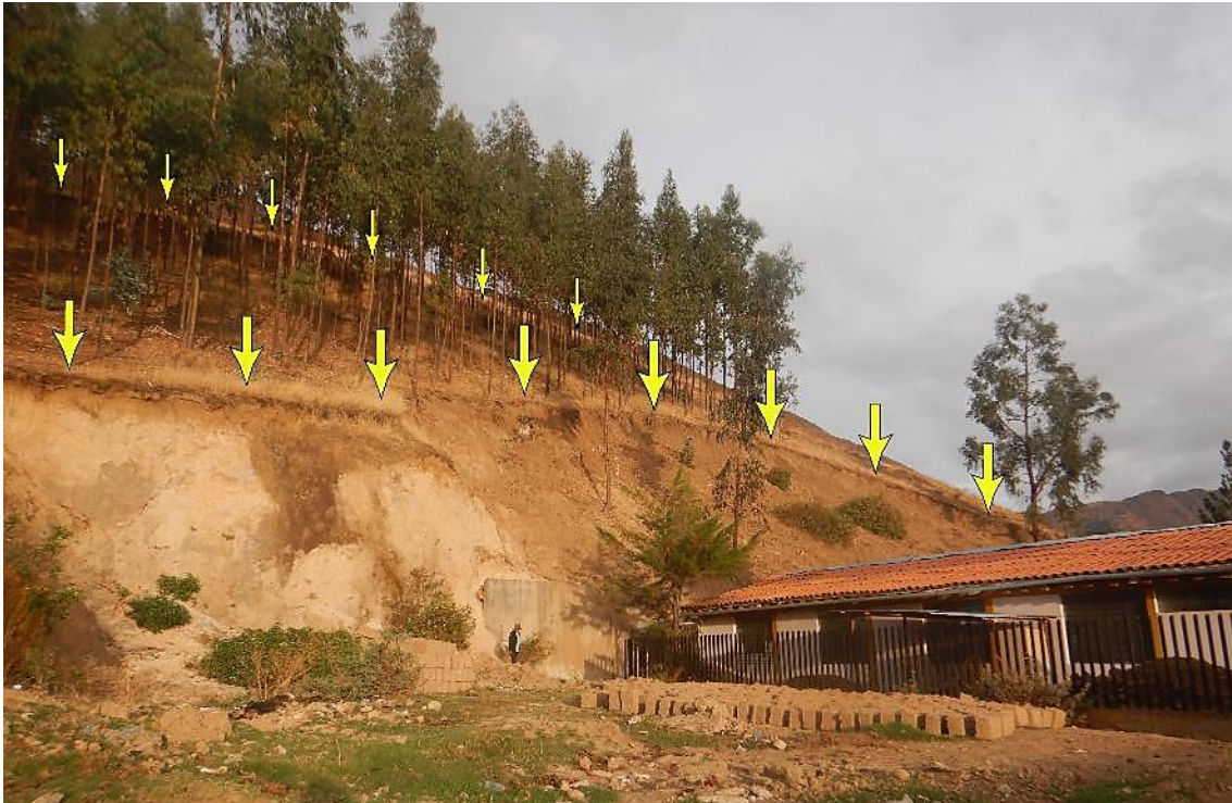
Figura 11. Vista de dos escarpes recientes Las flechas color amarillo demarcan las reactivaciones del deslizamiento antiguo (escarpes recientes), ubicadas muy cerca ( \approx 25 m) de la posta de salud del poblado de Querco, el cual es protegida por un muro de contención de 4 m de ancho y 57 m de largo. Coordenadas referenciales UTM WGS-84, 18S: E: 502723; N: 8454529 (tomada el 2023).
