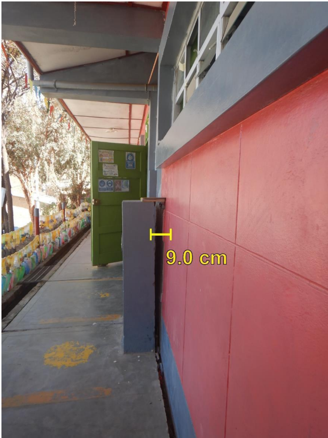
Figura 16: Afectación de la escuela primaria Querco N°22159, con grietas en las paredes y puertas. Además, se registró la inclinación de la pared en 3° hacia el SW y se observa la separación del muro del medidor en 9.0 cm de la pared.
