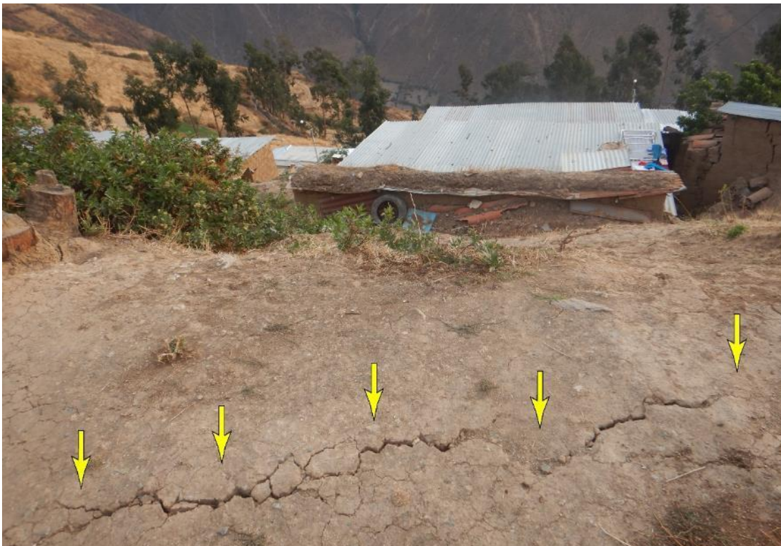
Figura 12. Grietas tensionales en el terreno de hasta 3.0 m de longitud, 3.0 cm de ancho y 5.0 cm de profundidad visible. Podría afectar viviendas ubicadas a solo 5 m por debajo de esta. Coordenadas referenciales UTM WGS-84, 18S: E: 502702; N: 8454482.
