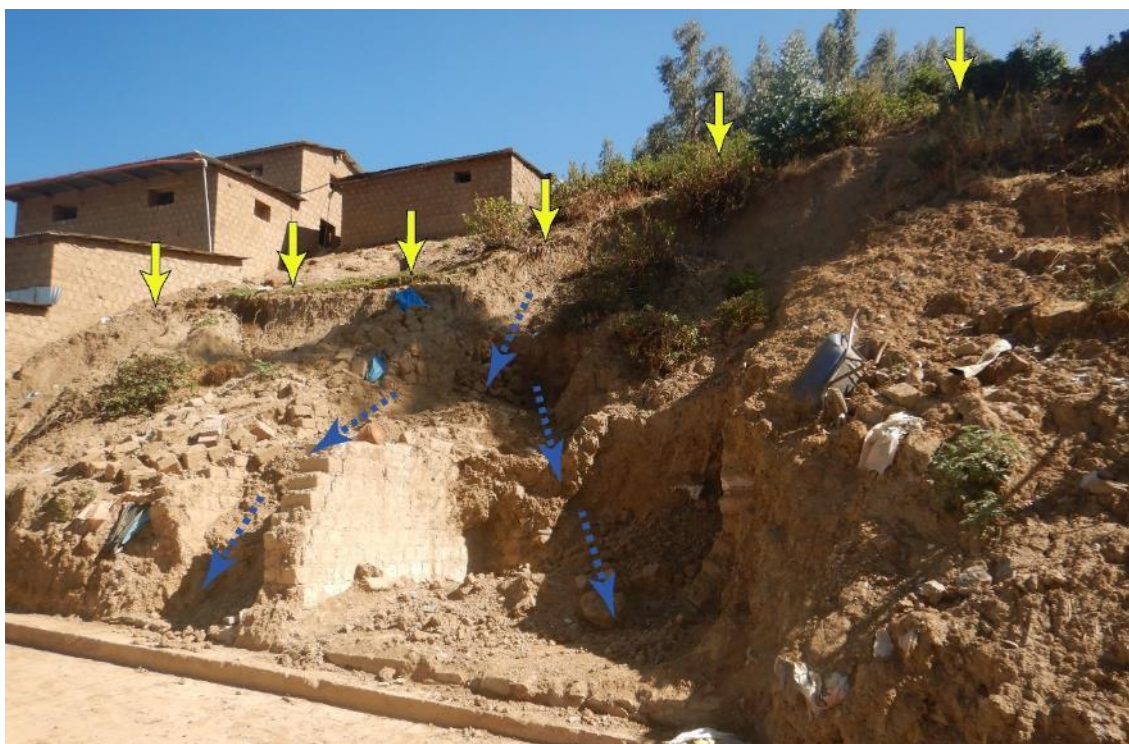
Figura 18. Vivienda de adobe destruida producto de la reactivación del deslizamiento señalada con flechas color amarillo y en flechas azules, la surgencia de agua SA 5 que en temporada de lluvias discurre por debajo de las viviendas (actualmente seco). Las paredes de las viviendas alrededor del escarpe se muestran agrietadas con longitudes de hasta 3.0 m en. Coordenadas referenciales UTM WGS-84, 18S: E: 502712; N: 8454463.
