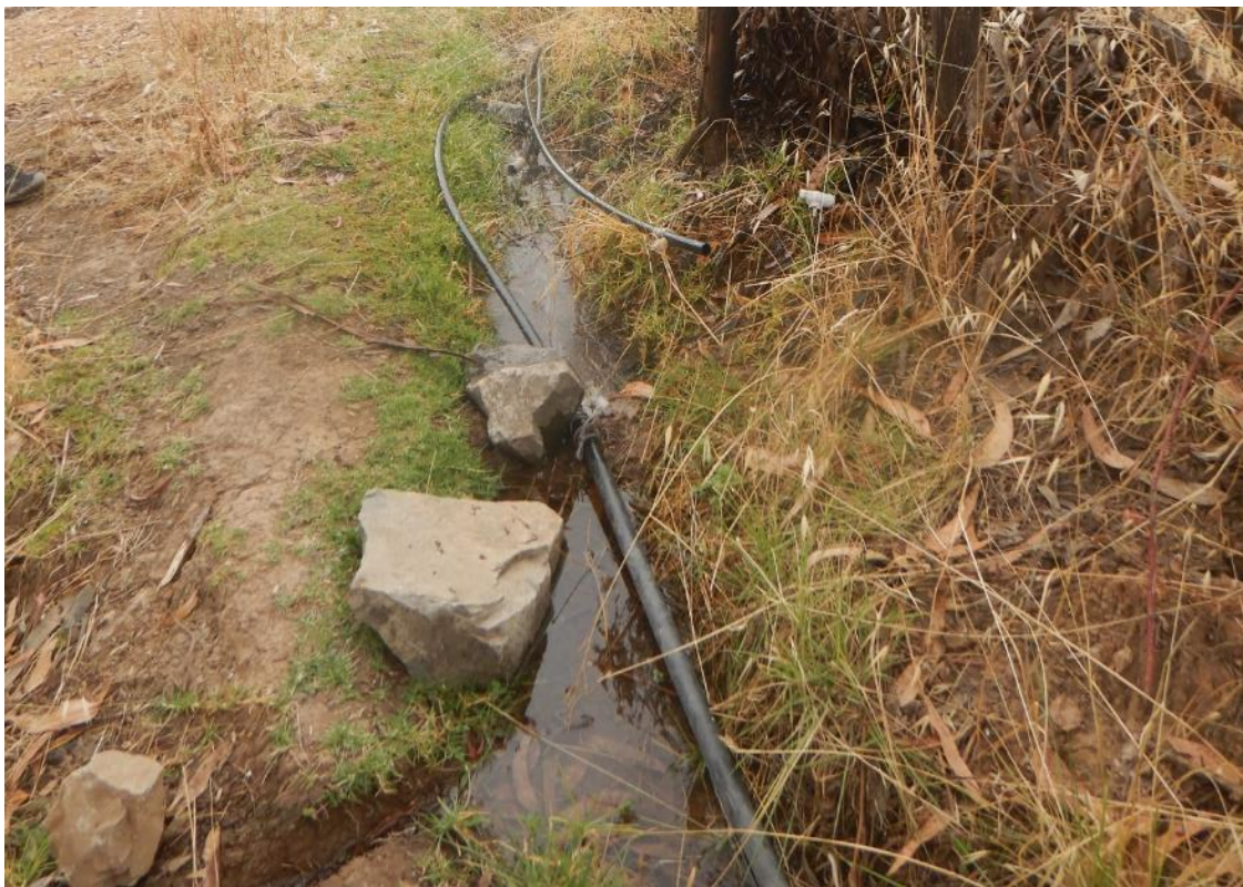
Fotografía 6. Canal de riego sin revestimiento que satura el terreno constantemente, lo que conlleva a la pérdida de la cohesión del terreno y dando lugar a la ocurrencia de movimientos en masa. Coordenadas referenciales UTM WGS-84, 18S: E: 502658; N: 8454761.
