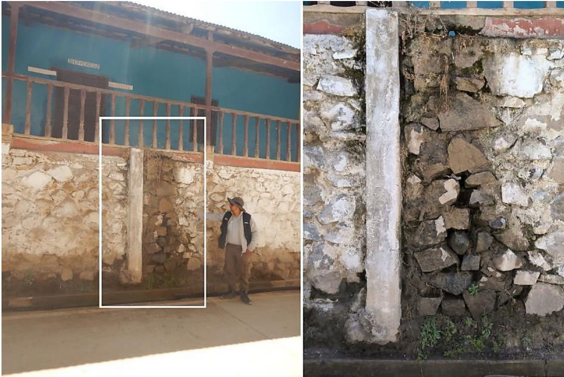
Figura 19. Vista del local comunal, el cual muestra las filtraciones de agua que salen de sus paredes, el cual según indican los pobladores, esta se habría incrementado este año a raíz de las fuertes precipitaciones. Corresponde a la surgencia de agua SA 6. Coordenadas referenciales UTM WGS-84, 18S: E: 502572; N: 8454577.
