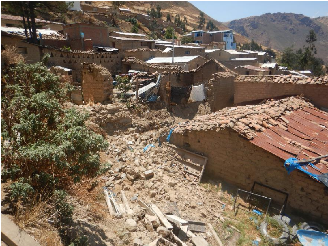
Fotografía 3. Vista de vivienda de adobe colapsada producto de la reactivación de deslizamiento y surgencias de agua subterráneas. Coordenadas referenciales UTM WGS-84, 18S: E: 502550; N: 8454504.
