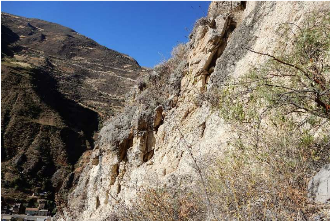
Fotografía 7. Vista de sistema de fracturas ortogonales muy abiertas, que dan lugar a una geometría de columnas divididas en bloques favoreciendo la rotura por volcamiento.
