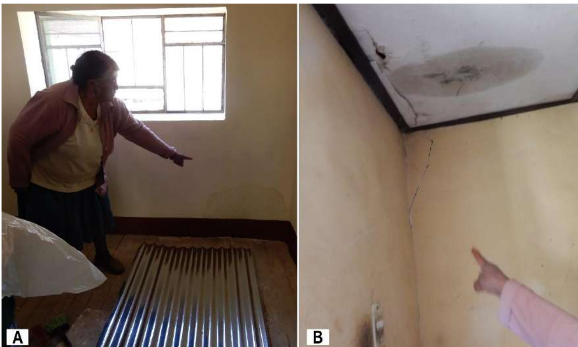
Figura 19. Vestigios de caídas de rocas en pared (A) y techo (B) de vivienda. Coordenadas referenciales UTM WGS-84, 18S: E: 500428; N: 8618007.
