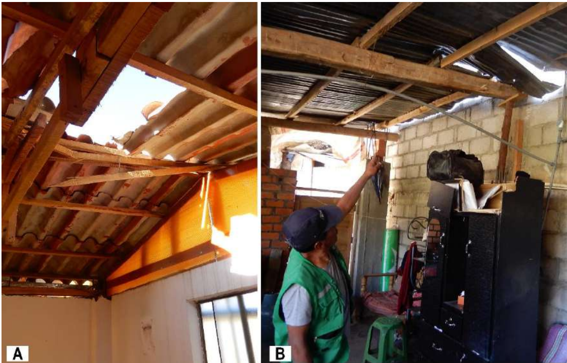
Figura 17. A. Vestigio del impacto de la caída de roca en el techo de hospedaje “Vista Alegre Izcuchaca”. Coordenadas referenciales UTM WGS-84, 18S: E: 500368; N: 8618026. B. Techo de vivienda continúa al hospedaje y de igual forma, afectado por la caída de roca reciente. Coordenadas referenciales UTM WGS-84, 18S: E: 500373; N: 8618023.
