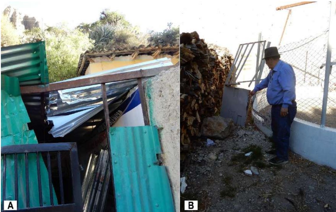
Figura 18. Registro fotográfico de la afectación directa de techo (A) y patio (B) del comedor popular “Keiko Sofia Izcuchaca”. Coordenadas referenciales UTM WGS-84, 18S: E: 500409; N: 8618013.
