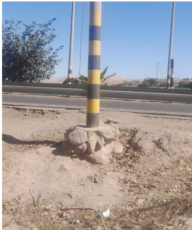
FOTO 9: Postes de concreto con cimentación erosionada.
