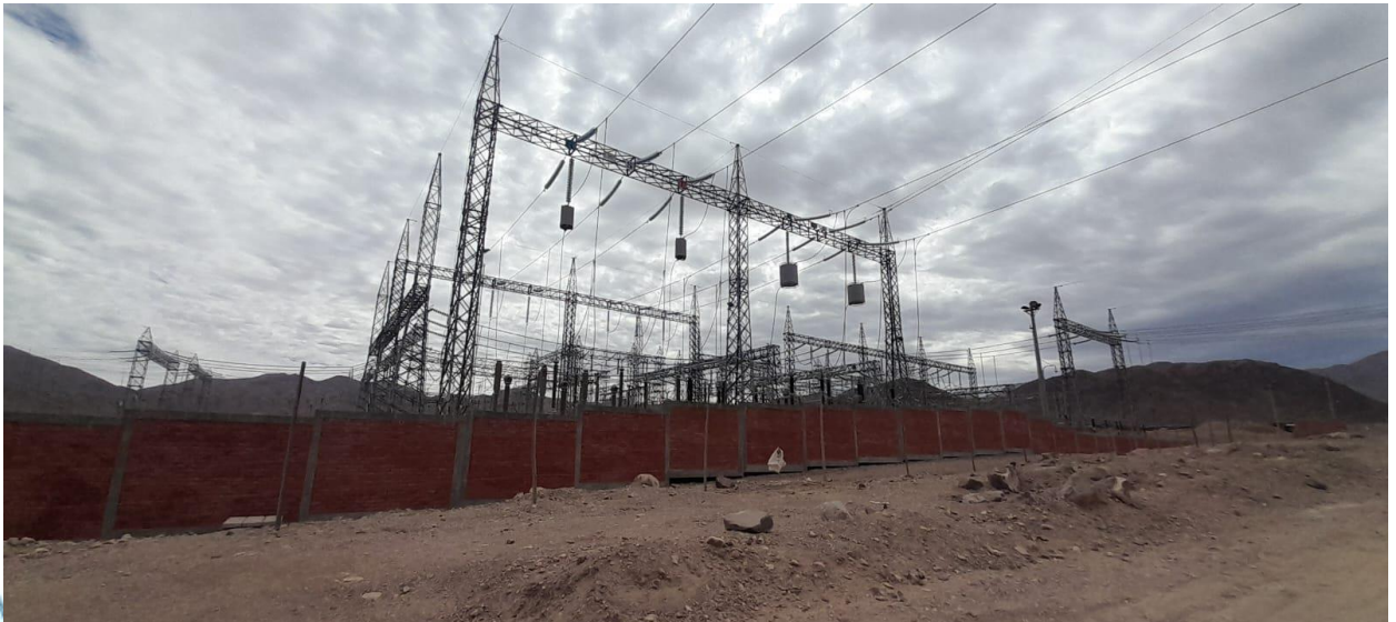
FOTO 4: Sub Estación Eléctrica Montalvo
