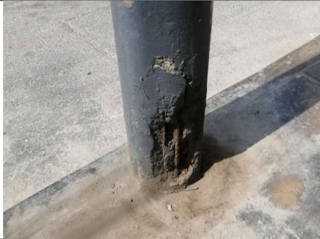
Postes de alumbrado público con las bases erosionadas y exposición del fierro. Riesgo de colapso.
