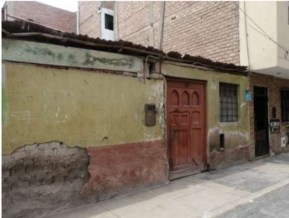
Vivienda con paredes de adobe erosionado
