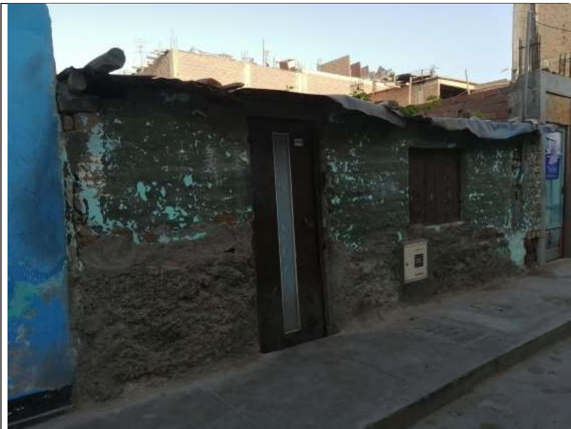
.Viviendas de adobe expuestas a la inundación fluvial
