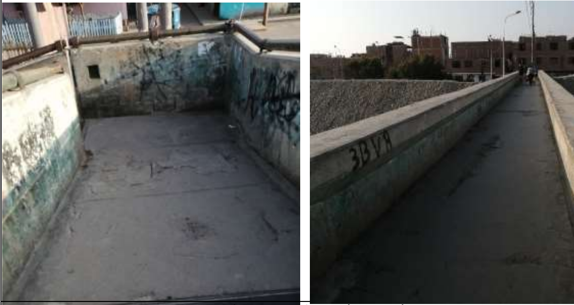
Puente peatonal que une el A.H. Márquez y el A.H. Víctor Raúl Haya de la Torre, presenta deterioro en su infraestructura, exposición de fierros y óxido.
