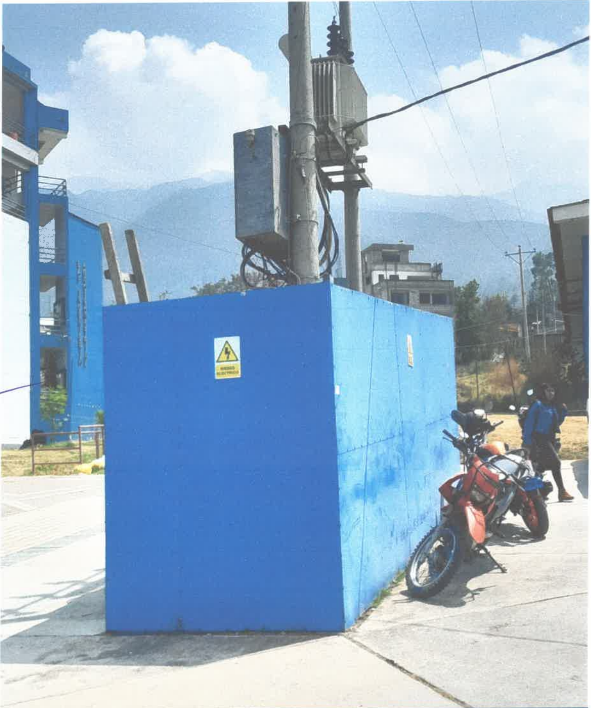
Foto No 3: se observa la subestación de energía eléctrica a tan solo 15 metros del cauce de la quebrada, con un flujo constante de agua, y situada en una zona de alta transitabilidad tanto de personas como de vehículos. Esta ubicación representa un peligro muy alto, que podría desencadenar en un riesgo muy alto de incendio dentro de la UNAMBA. Por lo tanto, se recomienda su reubicación inmediata.
