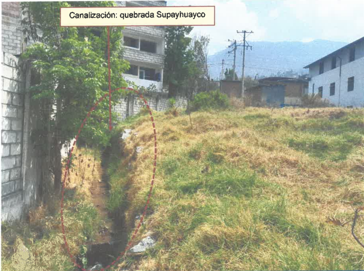
Foto No 1: se observa que la canalización de la quebrada Supayhuayco tiene dimensiones insuficientes. Durante periodos de máximas precipitaciones, existe un alto riesgo de inundaciones debido a lluvias intensas, lo que podría afectar significativamente una parte de la Ciudad Universitaria.
