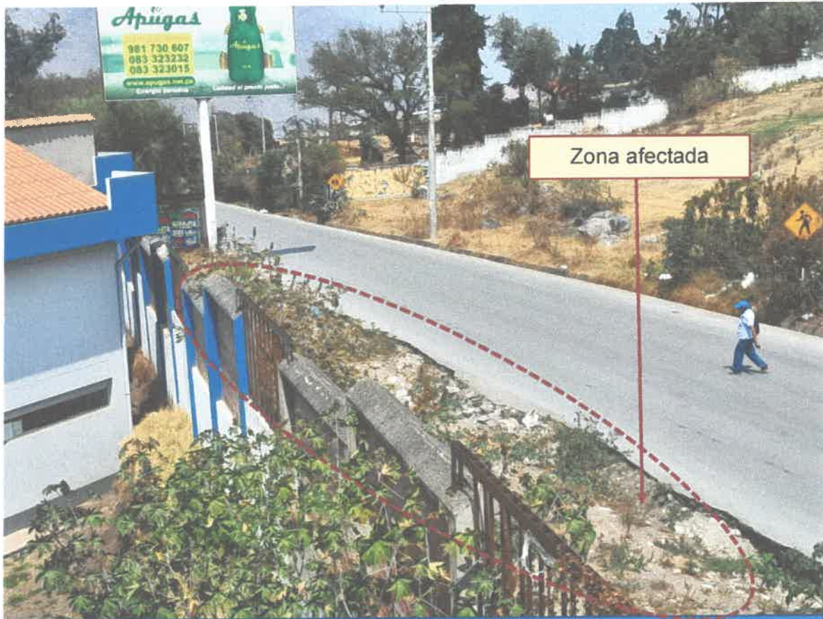
Foto No 2: se observa el socavamiento de la vía nacional, causado por la escorrentía resultante de las precipitaciones pluviales. Este fenómeno afecta directamente la infraestructura del laboratorio de suelos, el pabellón de Ingeniería Agroindustrial e infraestructura de data center de la UNAMBA
