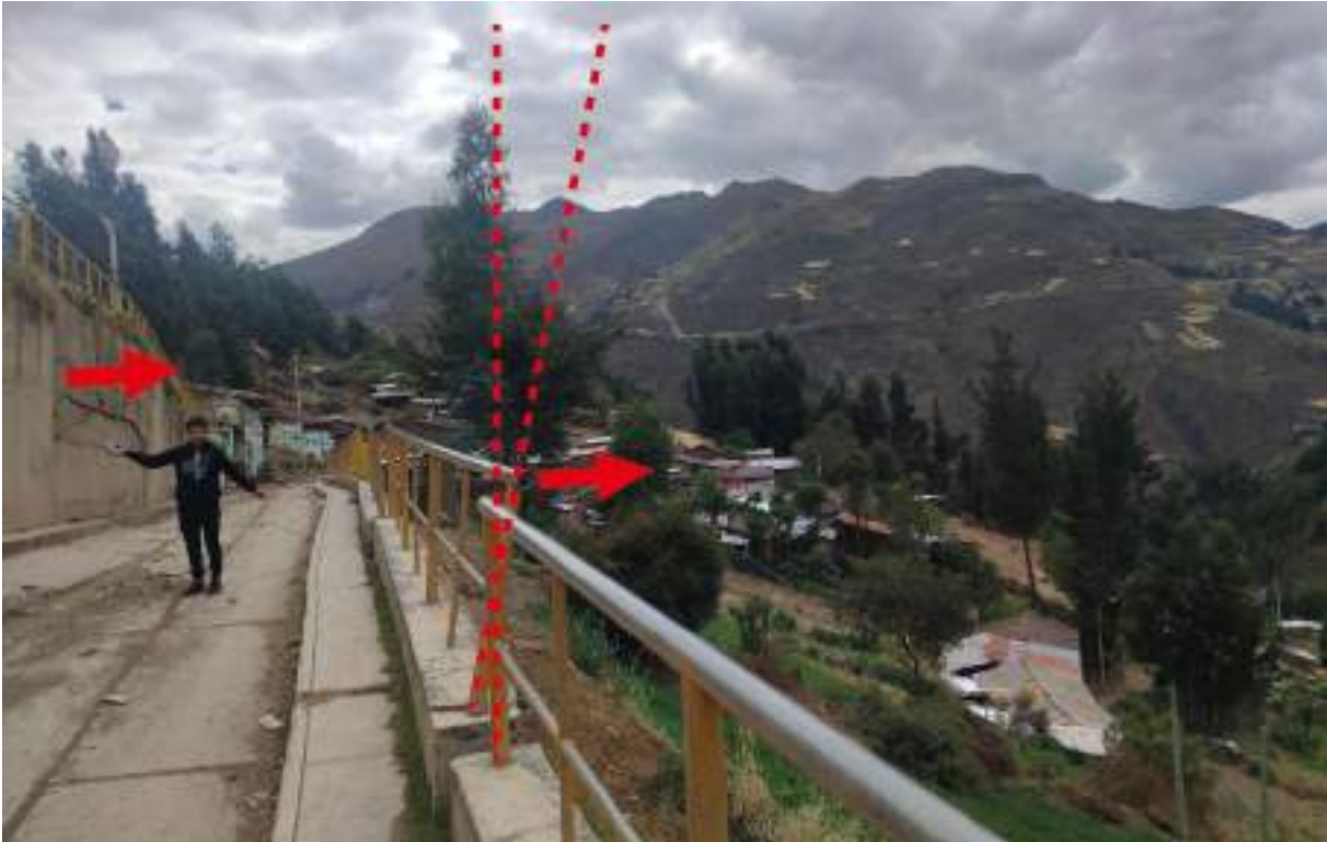
Figura 5.11. Muros y barandas inclinadas en dirección de los movimientos de deslizamientos hacia el Noreste. Coordenadas UTM WGS84: 261200, 8935645.
