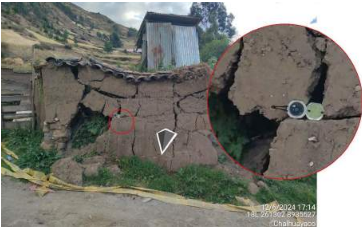
Figura 5.10. Muros destruidos en viviendas ubicadas en cuerpos de deslizamientos suspendidos con movimiento hacia el noreste. Coordenadas UTM WGS84: 261302, 8935527.
