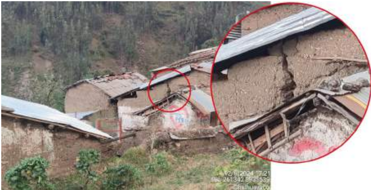
Figura 5.9. Grieta en viviendas en la parte baja de la ladera en cuerpos de deslizamientos suspendidos con movimiento hacia el Noreste. Coordenadas UTM 261342, 8935539.
