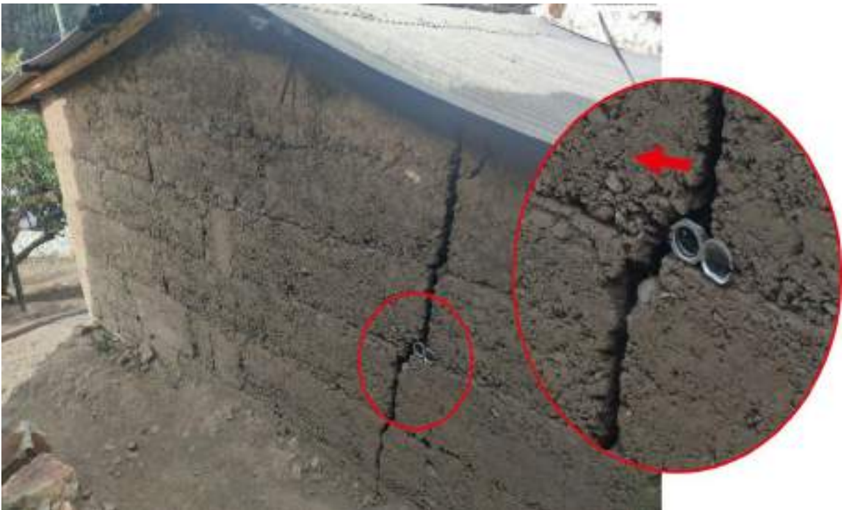
Figura 5.12. Muros con agrietamientos en dirección de los movimientos de deslizamientos hacia el Noreste. Coordenadas UTM WGS84: 261003, 8935658.
