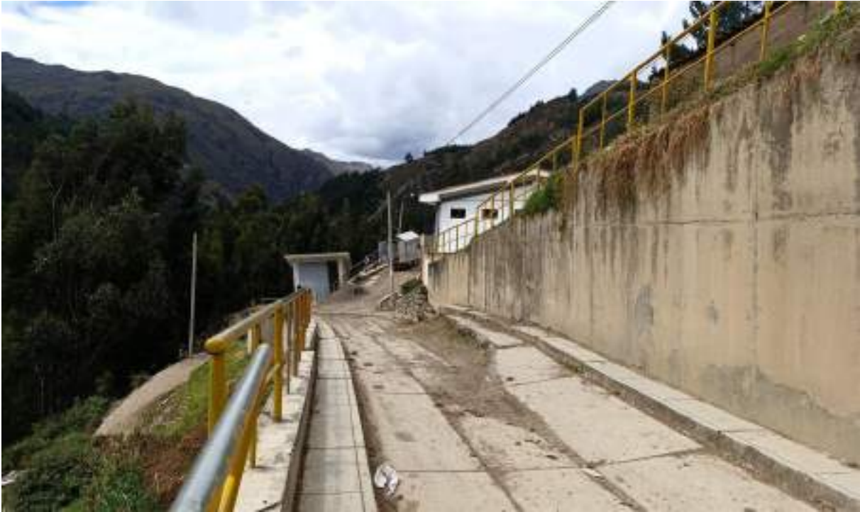
Fotografía 7. Vista de las calles de Challhuayaco deformadas, producto del asentamiento del terreno.
