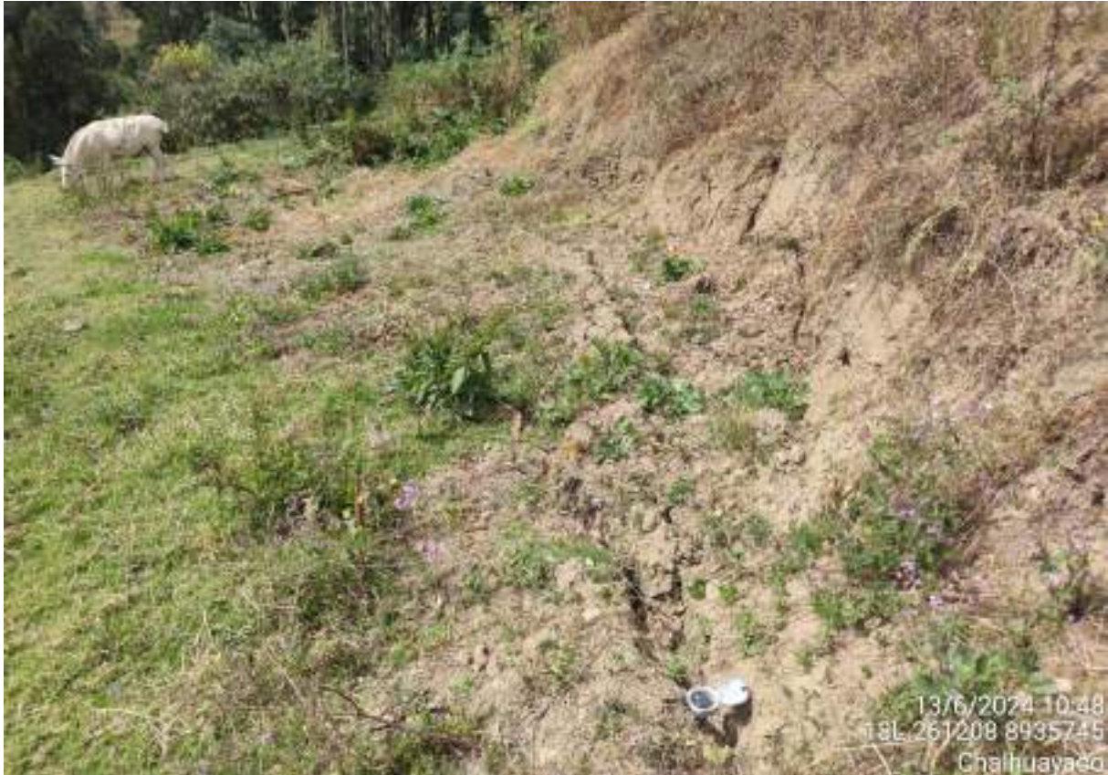
Fotografía 3. Vista de agrietamientos en el depósito coluvio deluvial del centro poblado Challhuayaco.
