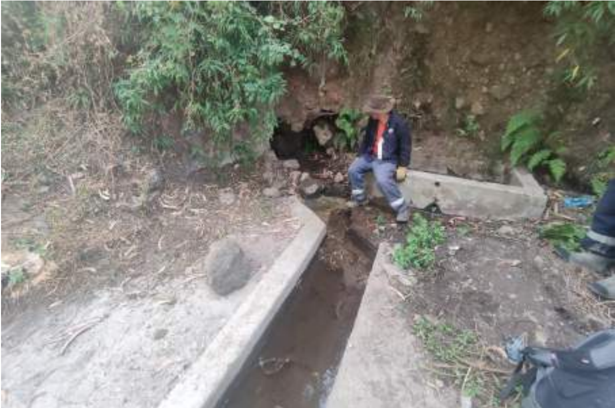
Fotografía 5. Surgencia de agua en la ladera del centro poblado Challhuayaco.
