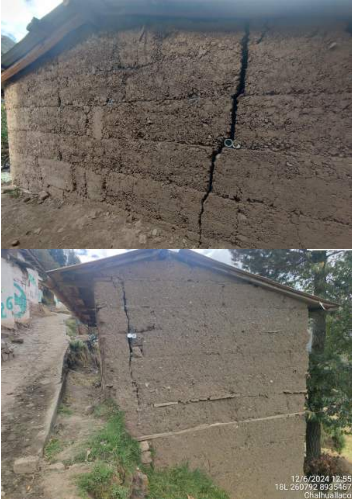
Figura 1. Vista de agrietamientos en las paredes de las viviendas de Challhuayaco.
