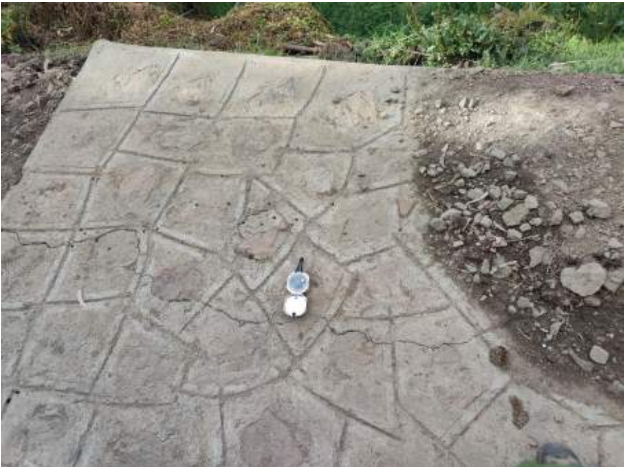
Fotografía 8. Agrietamientos en las veredas de las calles de Challhuayaco.
