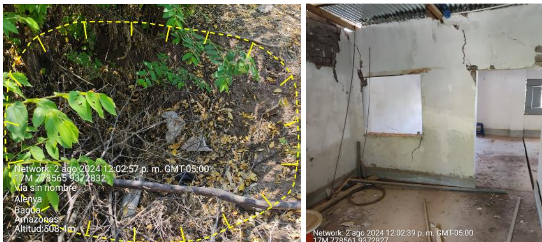
Figura 11. Hundimiento en terrenos agrícolas producto del reacomodo de los suelos por el exceso de humedad durante la temporada de lluvias (izquierda) y afectación a vivienda por humedecimiento de suelos y pisos (derecha).
