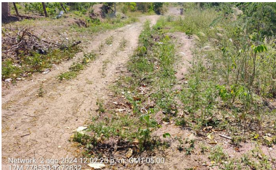
Fotografía 3. Afectación en trochas locales debidos a flujos de lodo.
