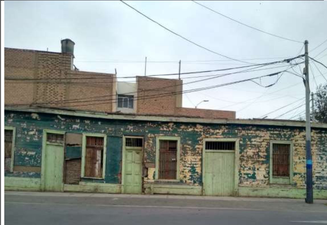
Edificaciones de madera en muy mal estado en Mz 21, Jr. Chanchamayo 218
