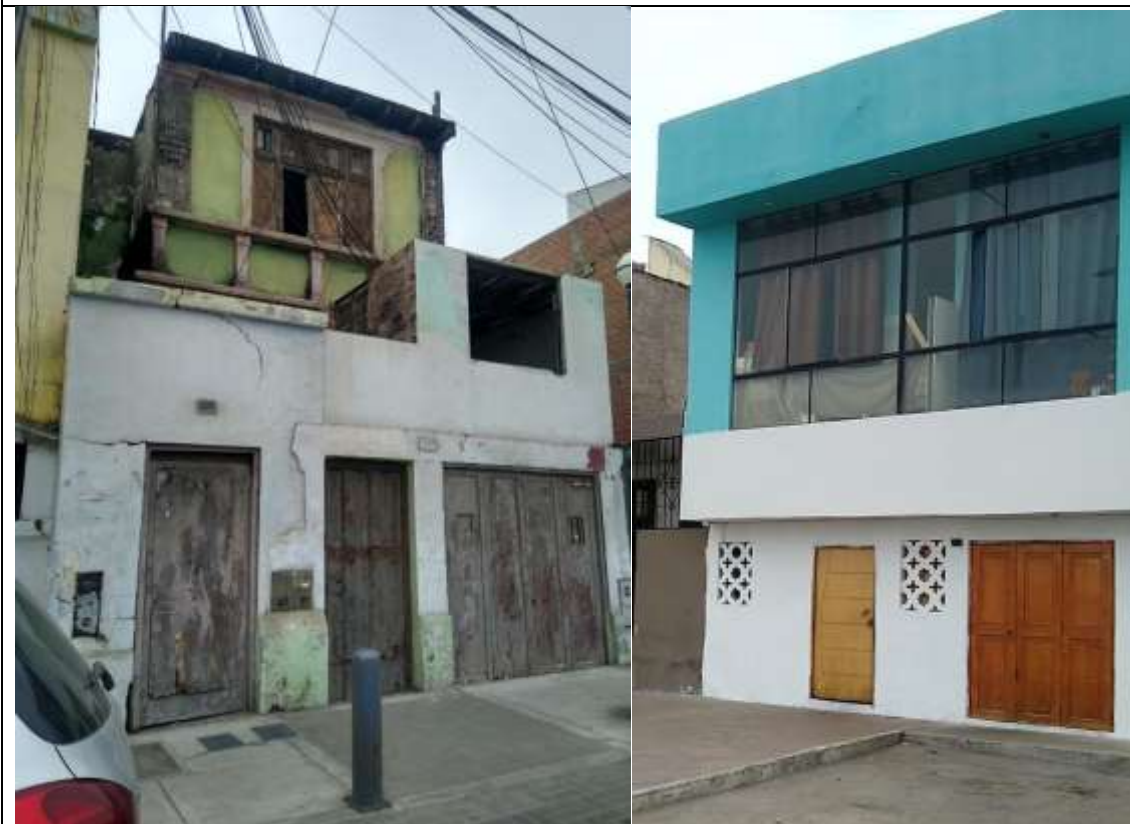
Edificación de adobe y quincha en mal estado. Vivienda de material noble en buen estado
