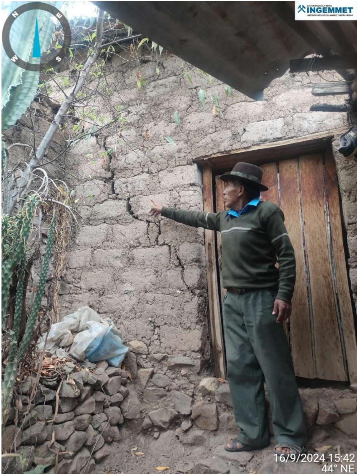
Fotografía 16. Vivienda agrietada ubicada al este del centro poblado de Pomabamba.
