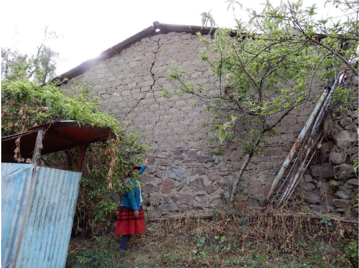
Fotografía 17. Vivienda afectada y con la presencia de grietas por la vibración del suelo a causa del sismo.
