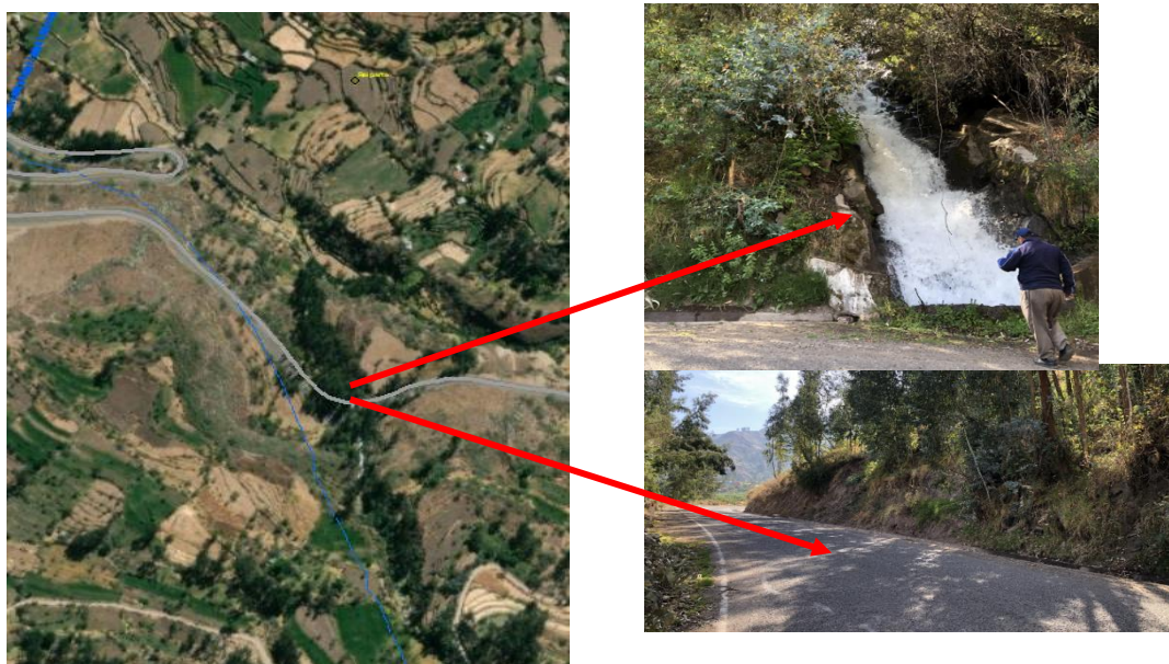
Figura Nº 16: Sector crítico – Canal de tierra inclinado
