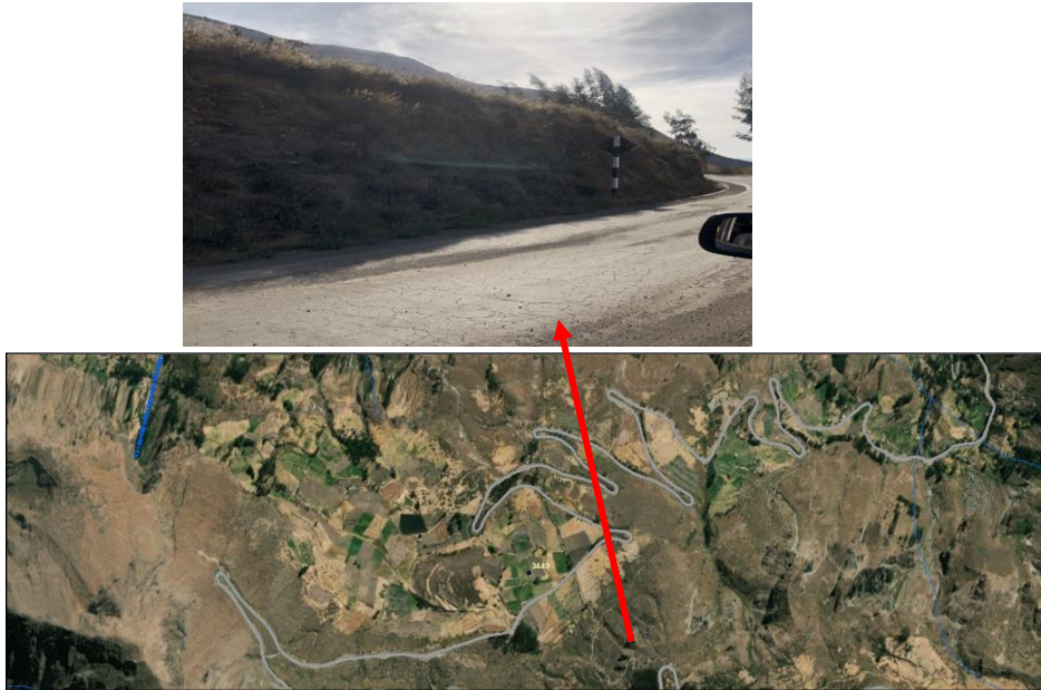
Figura Nº 13: Sector crítico – Laderas escarpadas por corte de carretera
