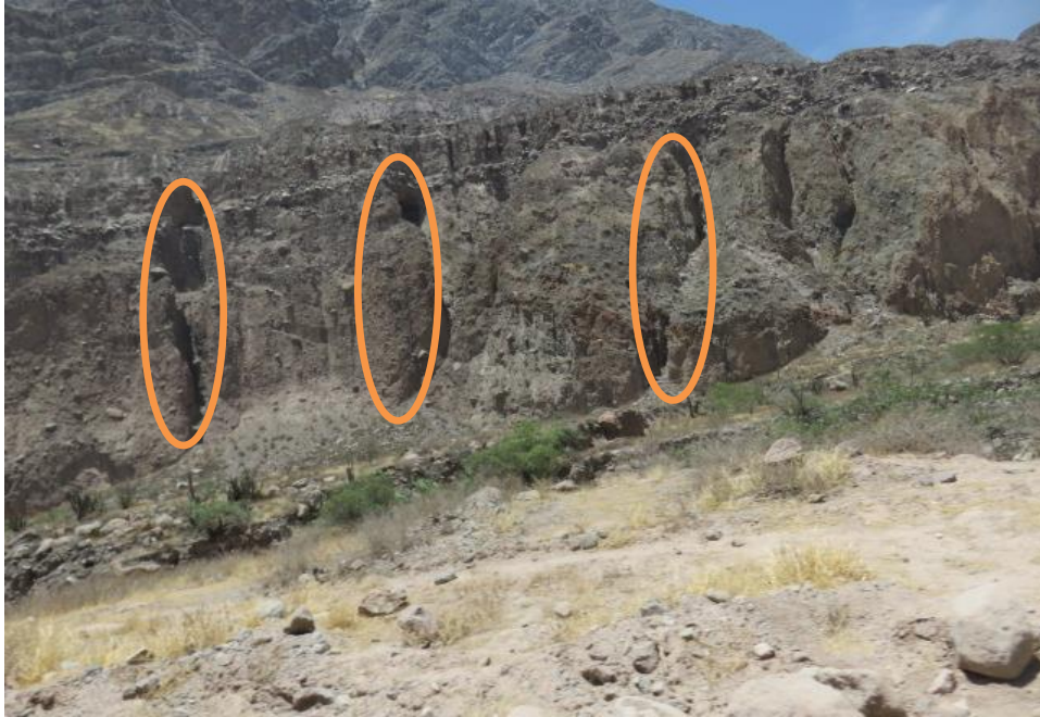
21. Vista de las grietas que se presenta a orillas del río Cotahuasi,
