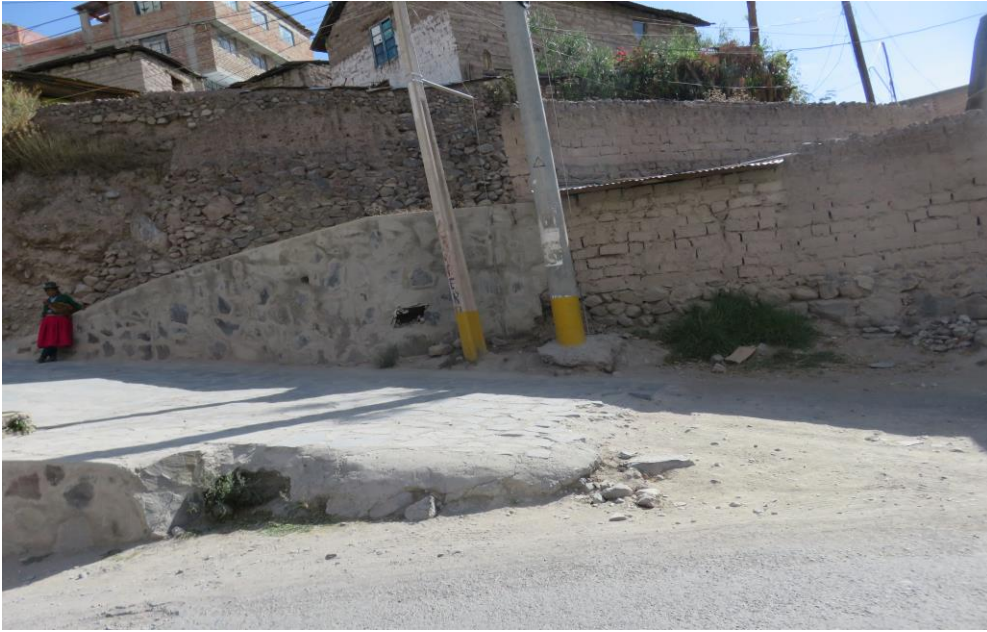
36. Asimismo la calle Casimiro Peralta no cuenta con drenaje
