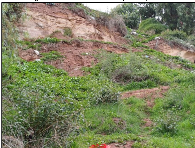
Fotografía 2. Material excedente (relleno) en ladera
