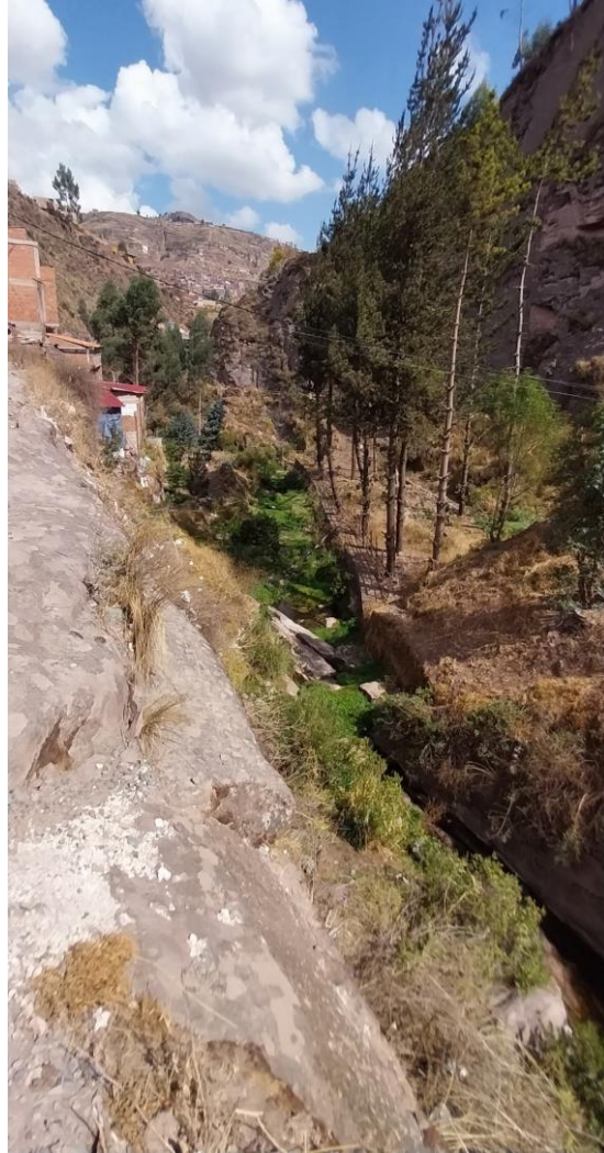
Foto 17 Trabajos de encausamiento de río chocco, sector norte de la APV. Unión San Martín
