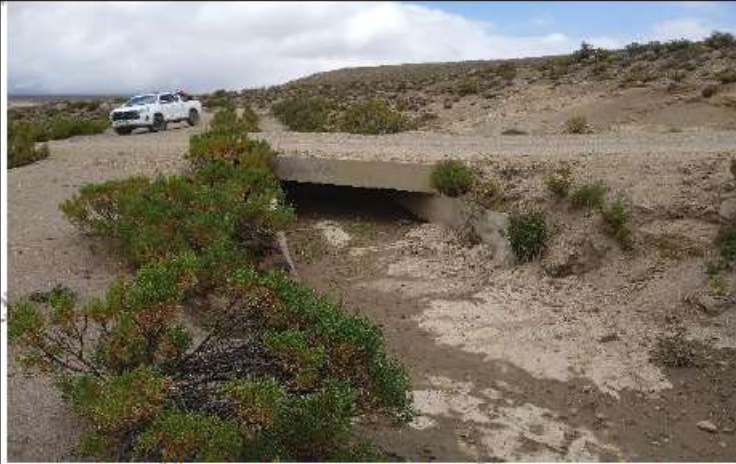
Figura 02. Vista del Puente vehicular aguas abajo del canal Tacalaya, no se tiene Resolución de autorización de ejecución de obra.
