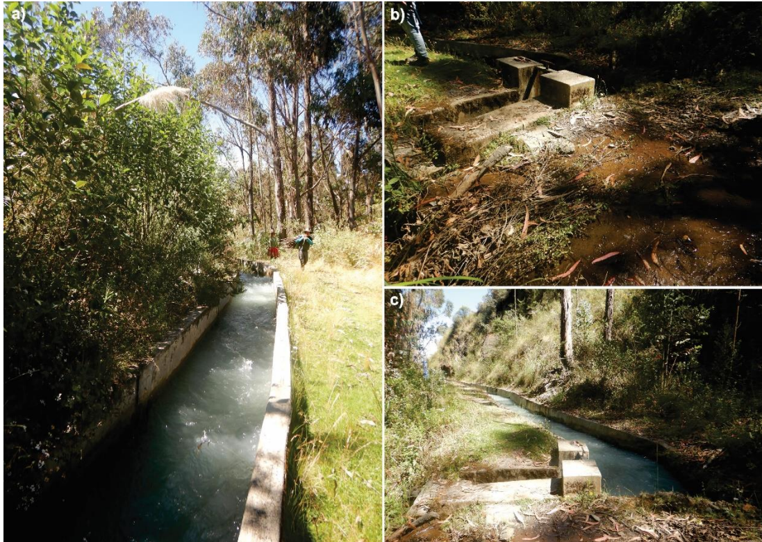
Figura 15. Vista del canal de riego revestido de concreto de 1.2 m de ancho con una profundidad de 1 m.
