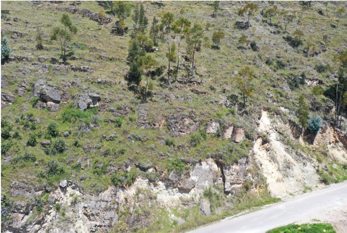
Fotografía 01. Derrumbes en la ladera este de la lomada en rocas volcano sedimentarias, Coordenadas WGS 84, 18s, X: 444501 & Y: 8702026.
